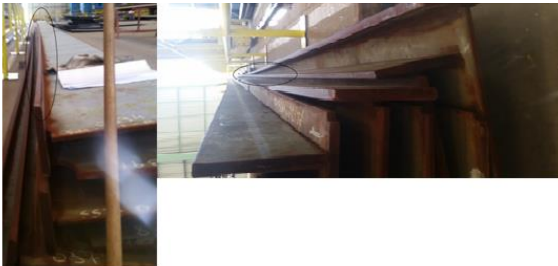
Figura 28 - Empeno dos elementos estruturais. (Fonte: AUTOR).
