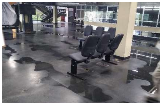
Vista do Hall Principal. Muita água empoçada.
