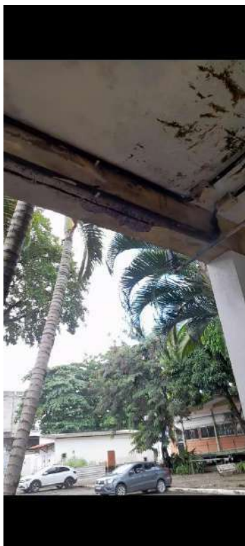
Foto 04 – Ferragem expostas na estrutura da passarela
