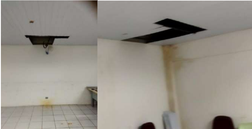
Figuras 2 e 3: infiltração no forro do Auditório.
