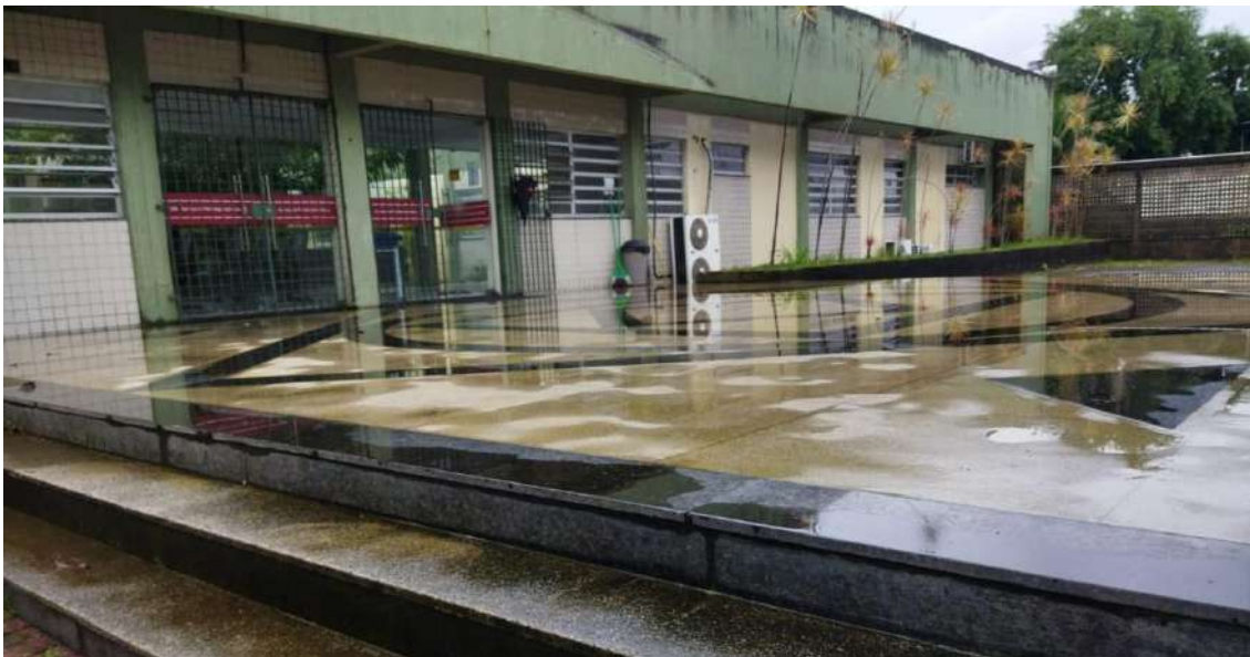
Figura 1: Acúmulo de água no Hall de ligação entre o UNATI e o SPA.
