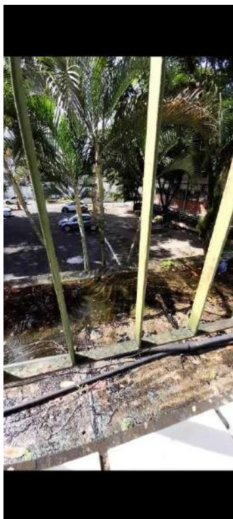
Foto 01 – Água acumulada na laje da passarela
