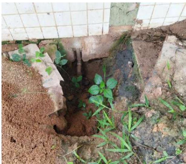
Figura 10: buraco localizado ao lado da fachada sul.
