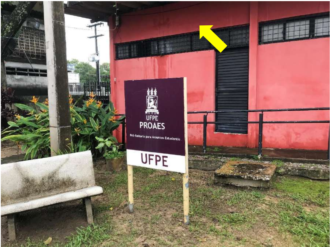
Figura 42. Vazamento da cobertura no Prédio da PROAES.
