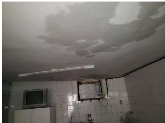
Foto 12: Infiltrações na Sala de Aulas Práticas que fica localizada sob o Auditório.
