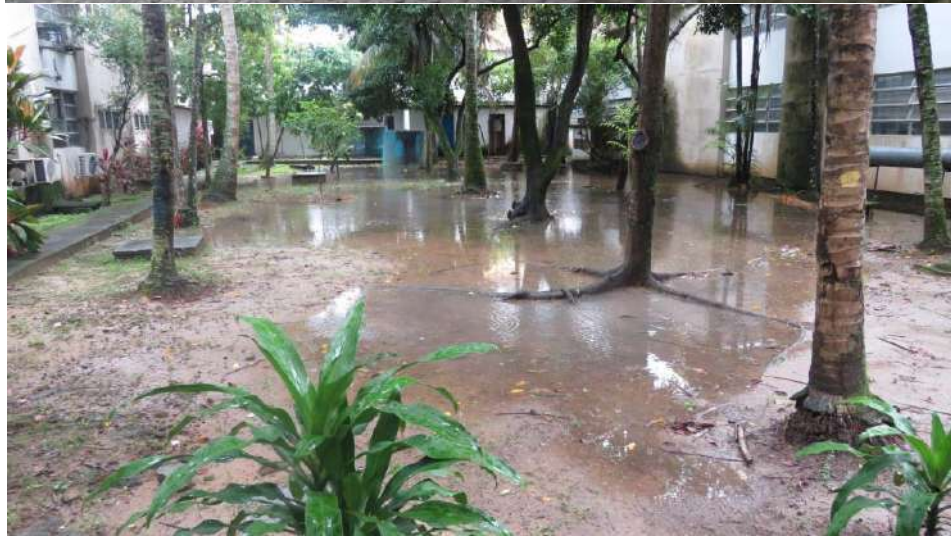
Figuras 11 a 15 - Alguns pontos de acúmulo de água indicando problemas na drenagem.
