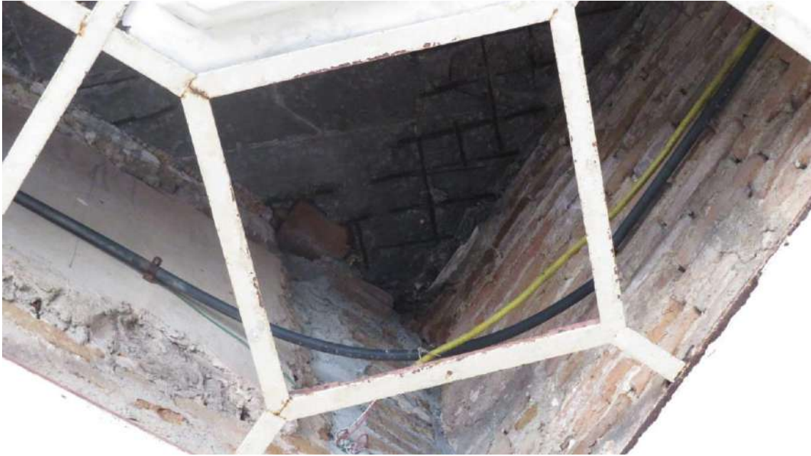
Figuras 44 a 50 - Acúmulo de água e problemas nas coberturas das circulações do primeiro e do segundo pavimento.
