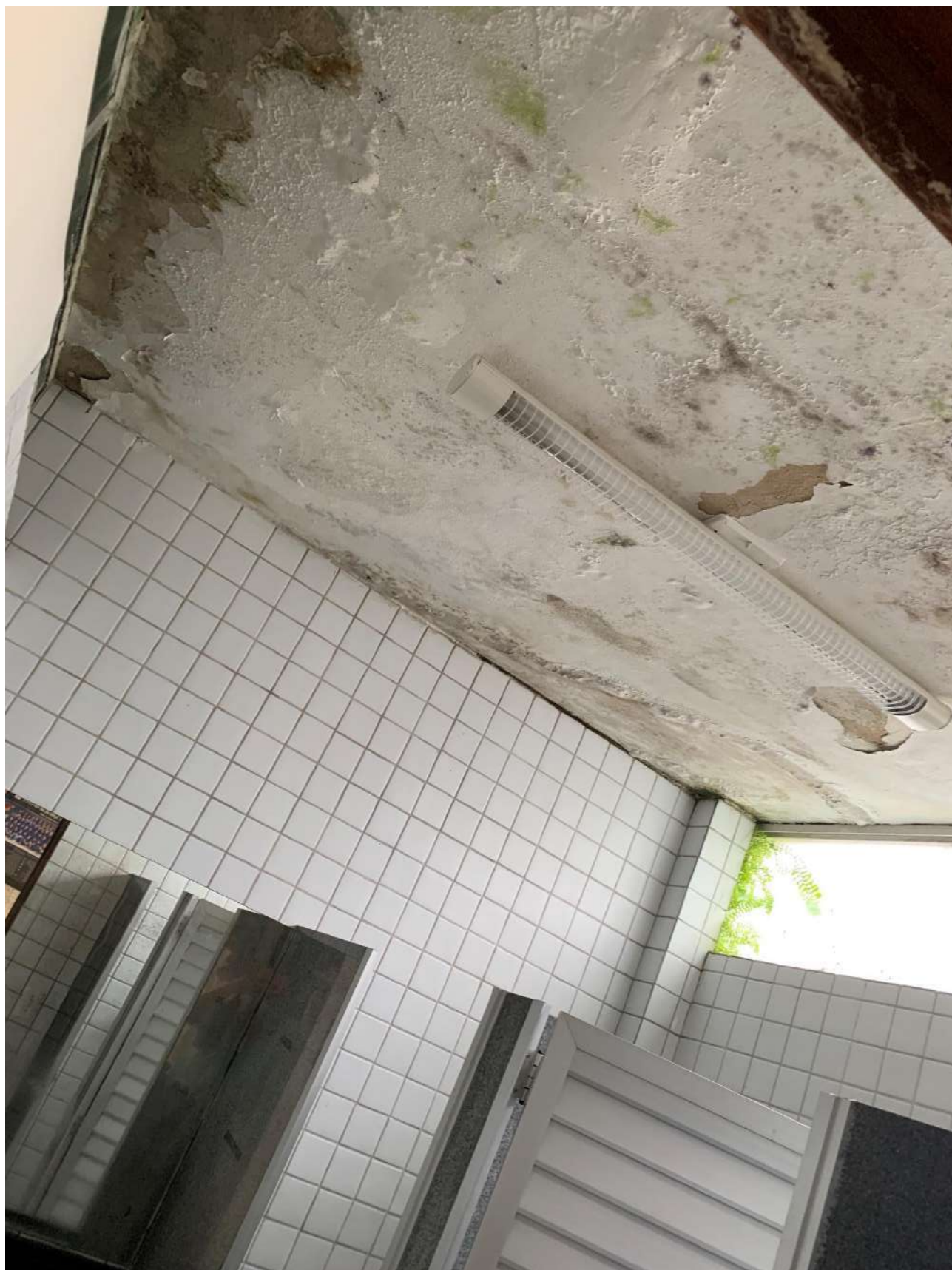
Figura 24. Infiltração no teto em banheiro no 1º pavimento CAP
