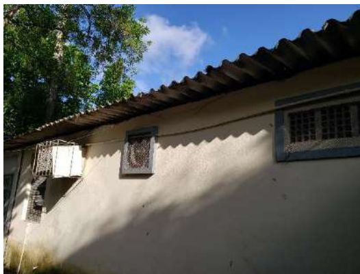
Foto 27: Telhas onduladas do Biotério onde precisam de manutenções constantes para evitar qualquer vazamento nos locais de criações de animais.
