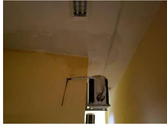
Foto 11: Corredores internos do Auditório com indicações infiltrações.
