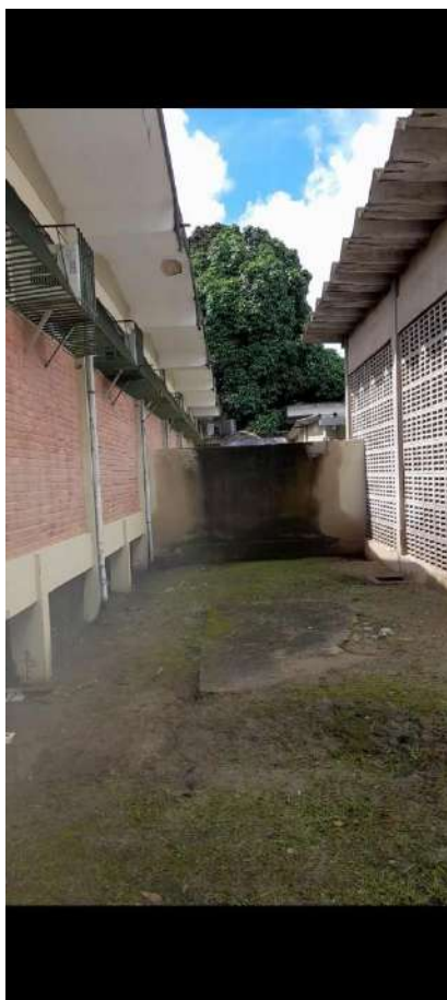
Foto 12 – Infiltração em muro
