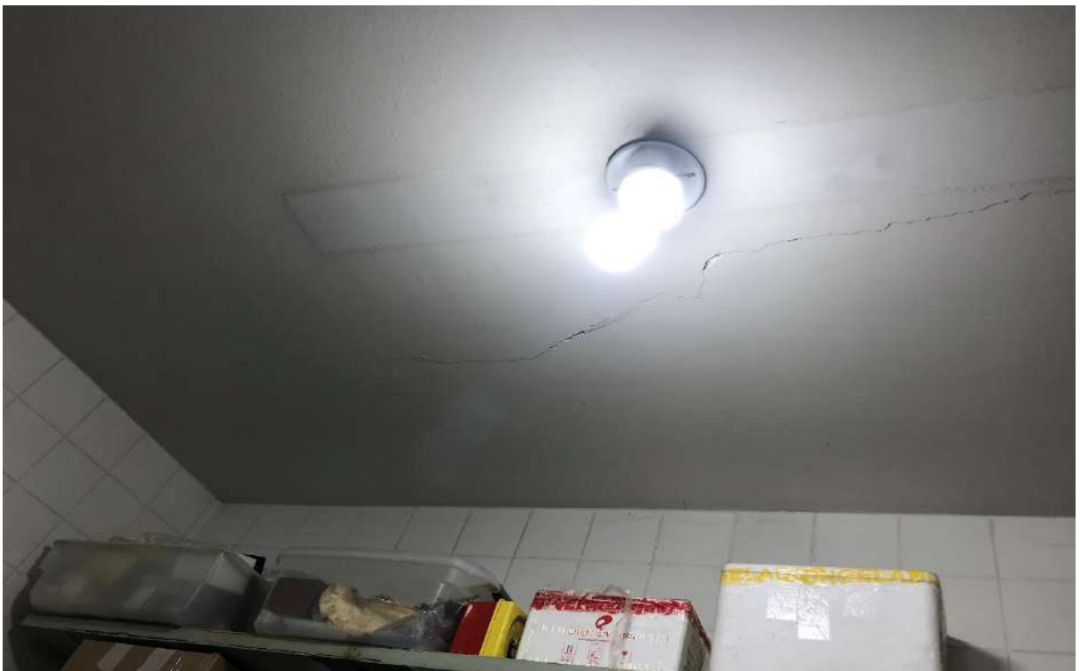
Figura 25. Rachadura em teto no Prédio Anexo de Anatomia CB
