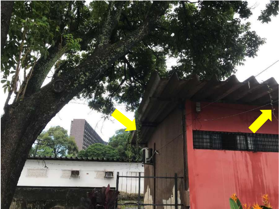
Figura 41. Vegetação acumulada sobre coberta da PROAES.
