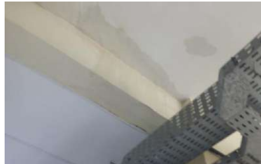
Infiltração na estrutura, próxima a instalações elétricas.
