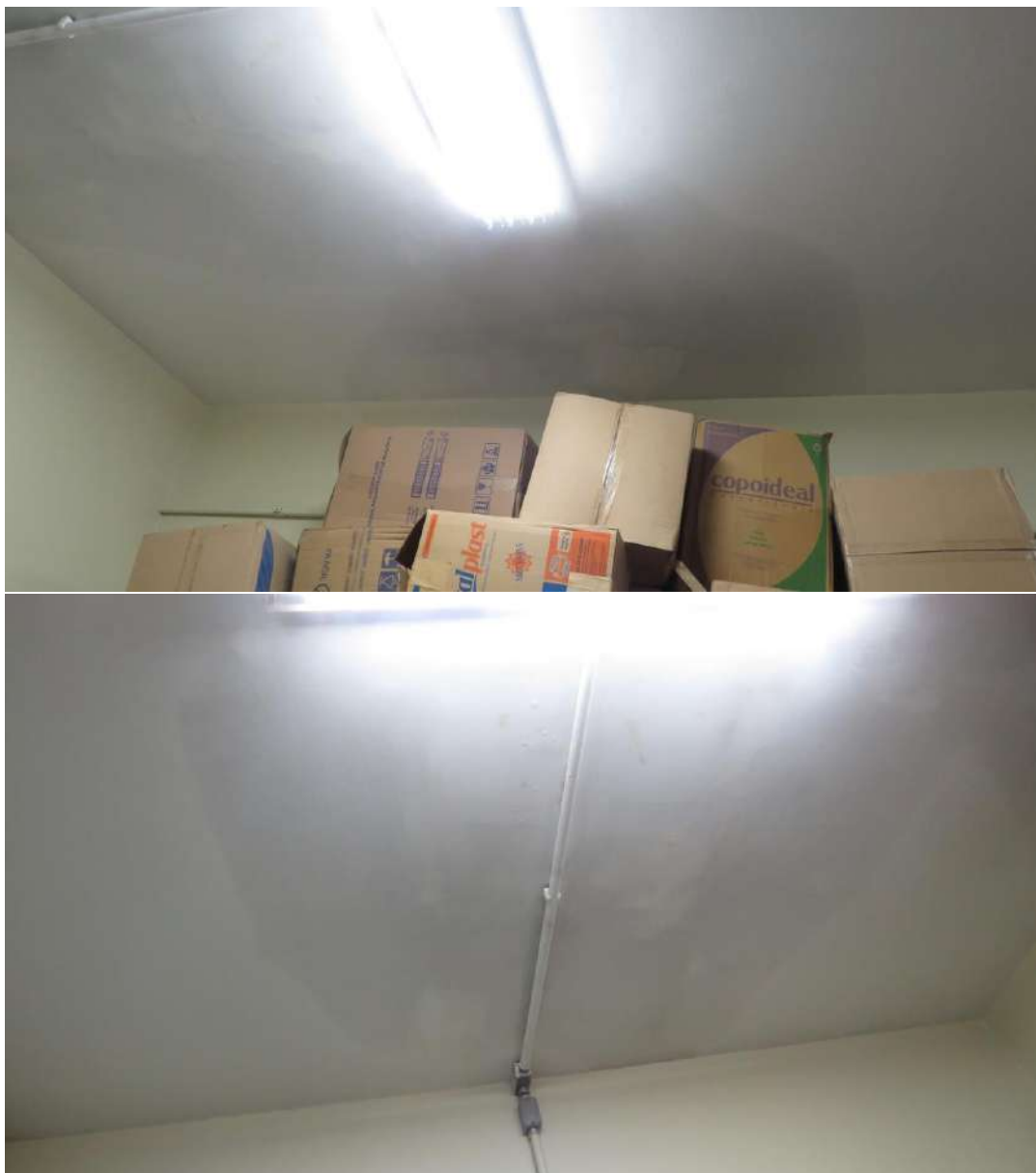
Figuras 1 e 2 - Infiltração na laje do Almoxarifado.
