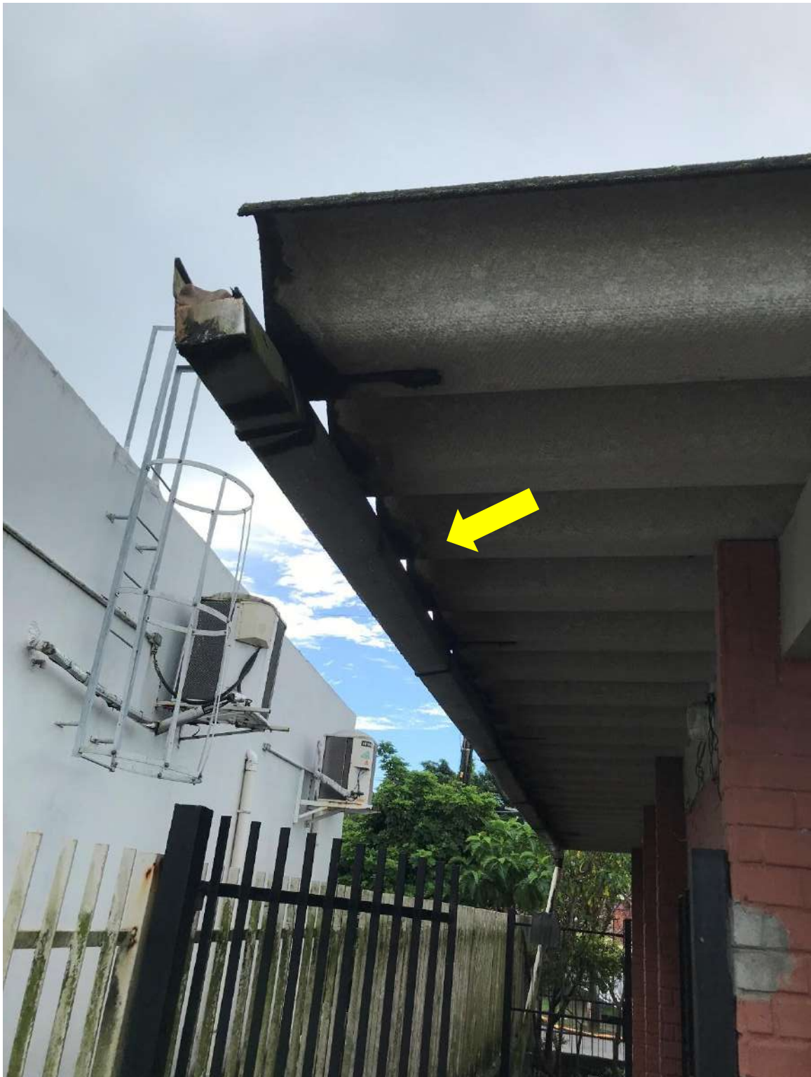
Figura 45. Calha insuficiente para drenagem da cobertura na Rádio Universitária
