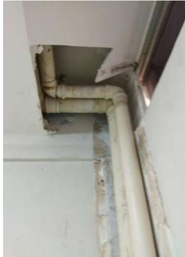
Tubulação exposta por dentro da sala de aula (com gotejamento)
