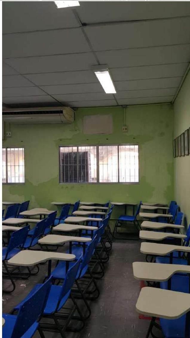
Figuras 25 a 29 - Infiltração em laje (passando pelo forro) e paredes do Auditório.
