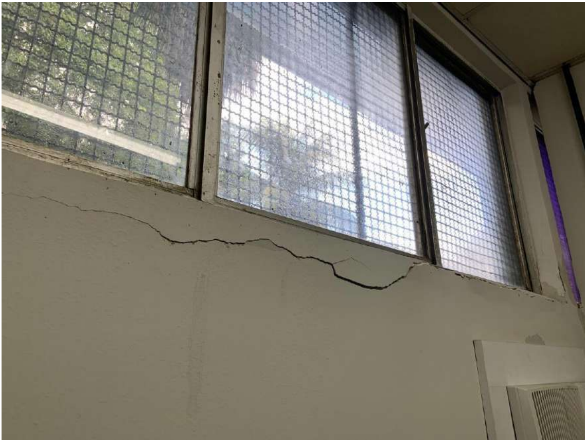
Imagens 03 e 04 - Sala de Apoio, com fissura e destacamento de pintura
