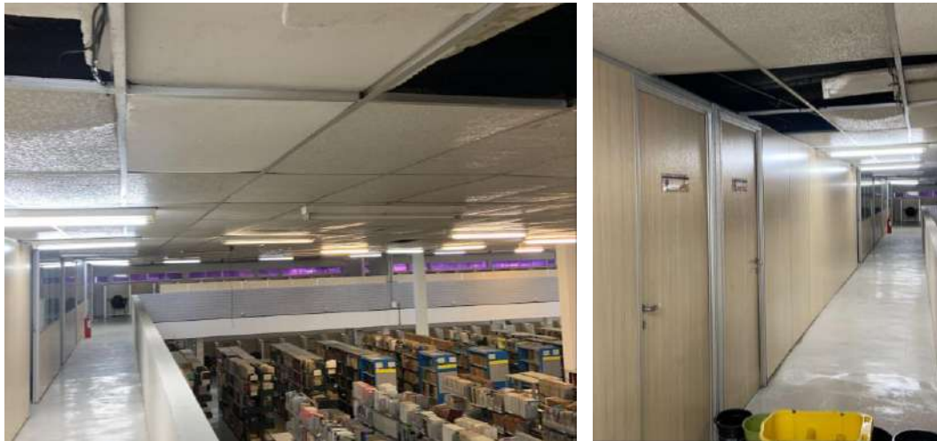
Imagem 08 - Circulação no mezanino/pavimento superior: peças ausentes no forro
