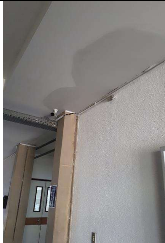
Vazamento gesso hall entrada
