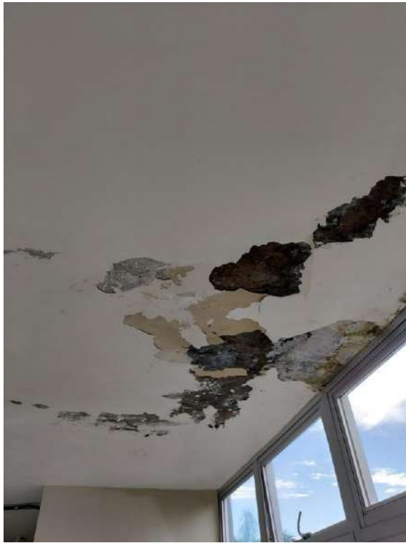
infiltração na laje
