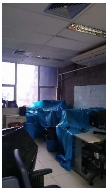
Sala central do 1º andar com infiltração proveniente da calha da cobertura. Plásticos foram colocados para proteger os equipamentos.
