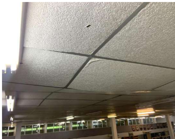
Imagem 28 - Deformidade no forro
