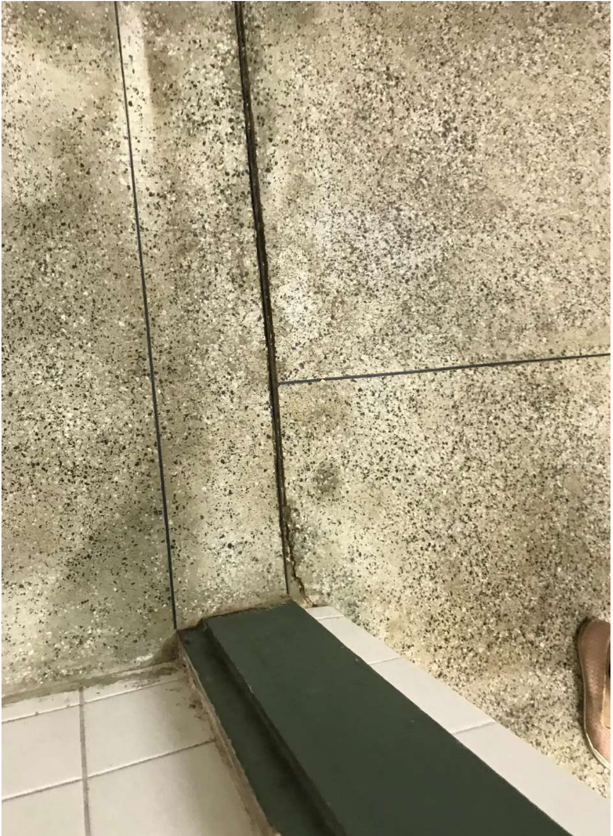
Figura 29. Detalhe de rachadura no piso do Apoio do Biotério Prédio Anexo de Anatomia CB
