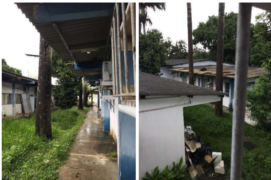
COBERTA COM TELHAS QUEBRADAS DEVIDO AS FOLHAS DAS PALMEIRAS- FÍSICA DOS SOLOS
