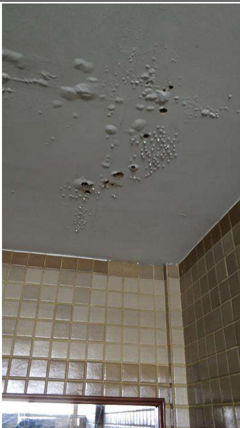
Vazamento teto banheiro 1° Andar
