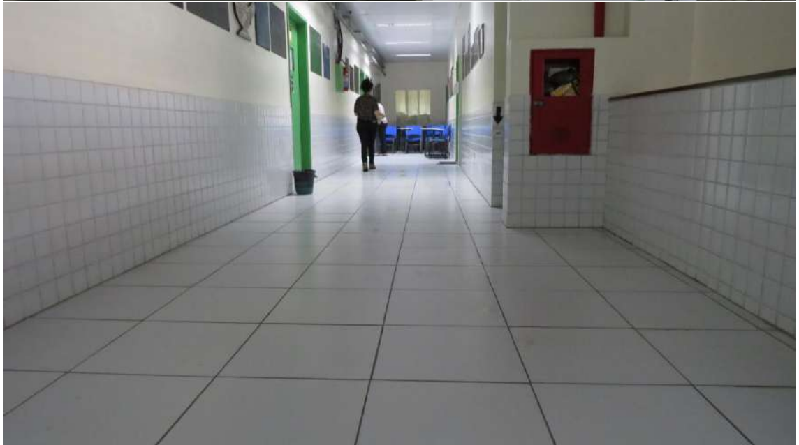
Figuras 13 a 21 - Infiltração em laje (passando pelo forro), paredes e pilar nos corredores.
