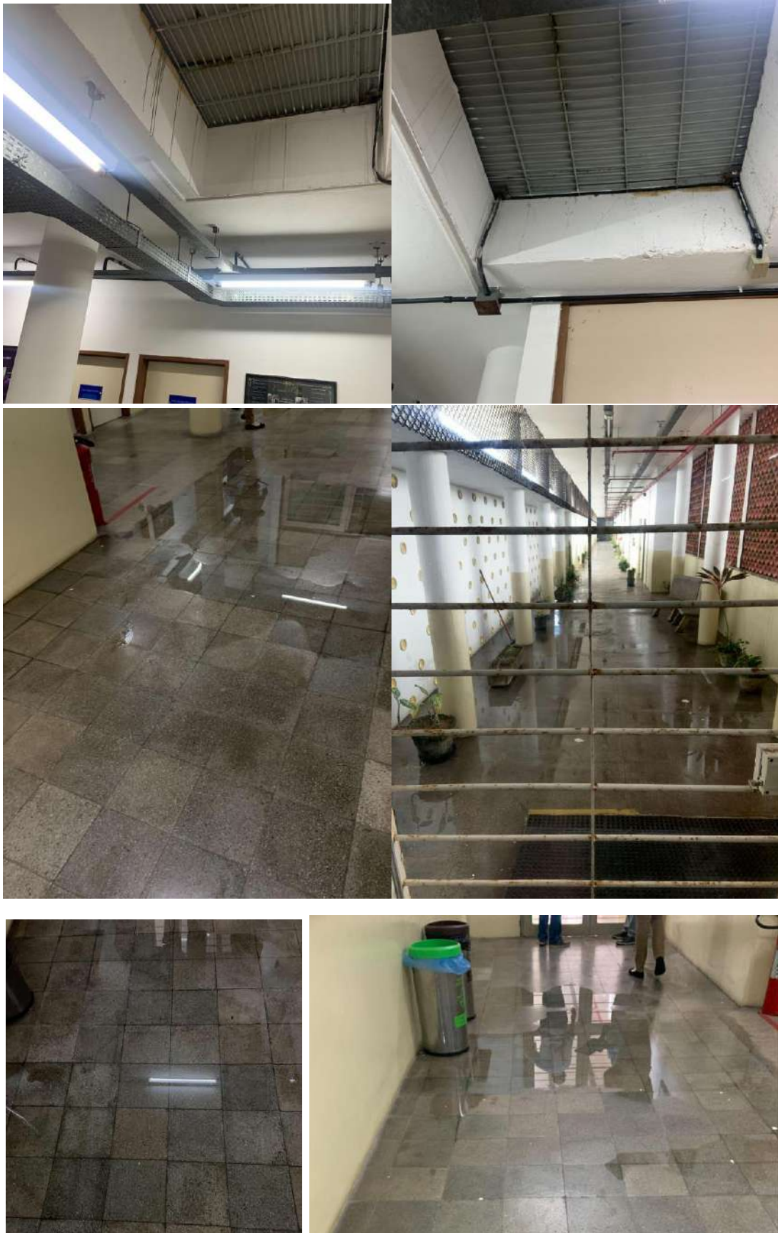
Imagens 19 a 24 - Pontos de alagamento e infiltração no 14º pavimento
