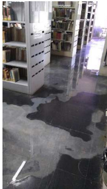
Biblioteca – acervo central. Muita água empoçada no piso.
