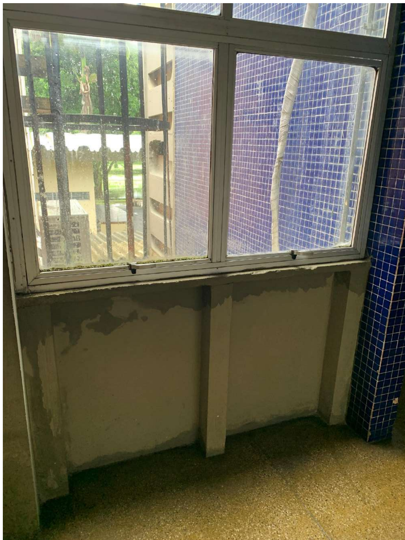
Figura 7. Infiltração pela esquadria no 2º pavimento CAp
