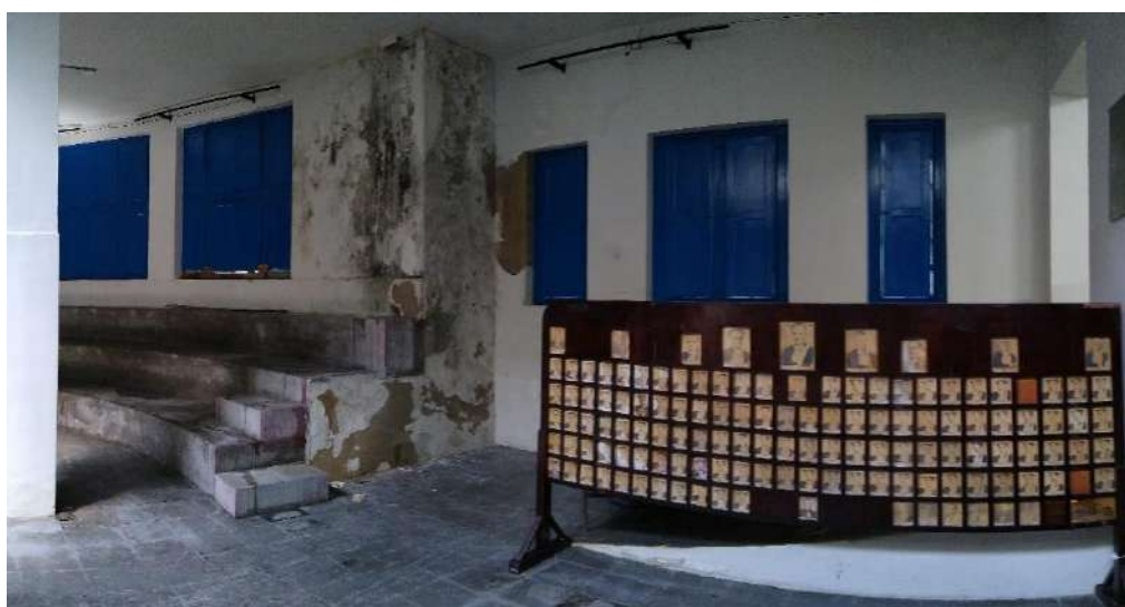
Anfiteatro – foto panorâmica. Grande infiltração.
