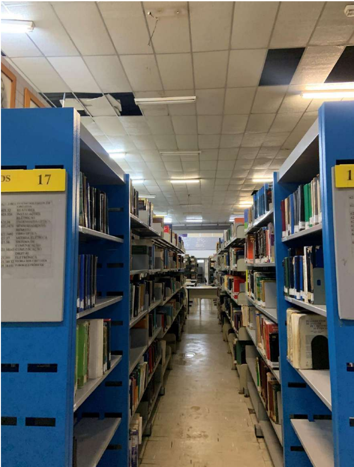
Imagem 06 - Ambiente do acervo: pontos de acúmulo de água, ausência de luminárias e de peças do forro
