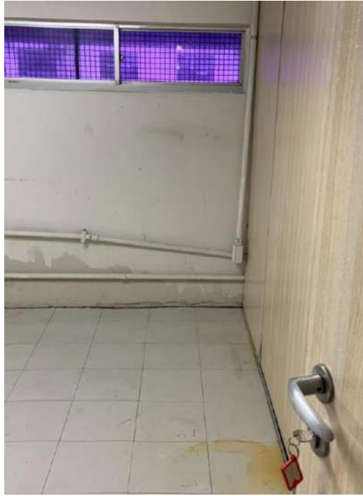
Imagem 09 - Sala de reunião com infiltração através da parede e manchas no piso
