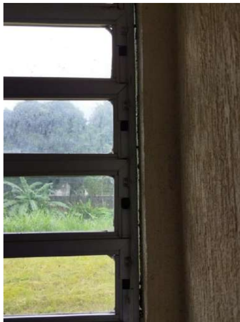
Figura 7: vão existente entre a janela e a parede da circulação.
