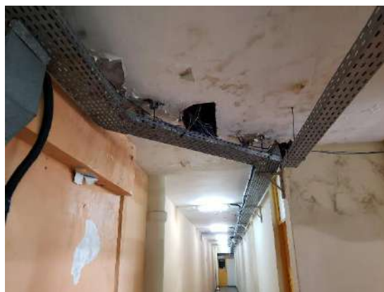
Foto 08: Fiação com risco de curto devido aos vazamentos no prédio.
