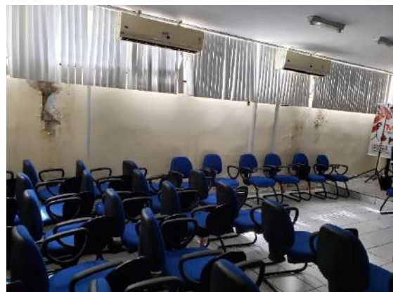
Foto 20: Sala de reunião com infiltrações advindas das janelas.
