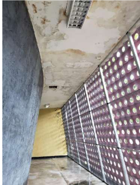
Foto 07: Local no Auditório, e do prédio, onde ocorre o pior vazamento, advindo de impermeabilização ineficiente.
