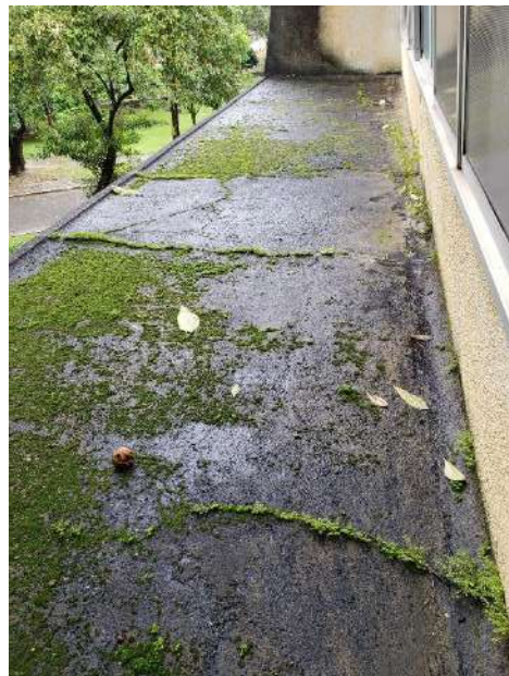
Foto 09: Aproximação da laje impermeabilizada do Auditório, onde ocorre o pior vazamento no prédio.
