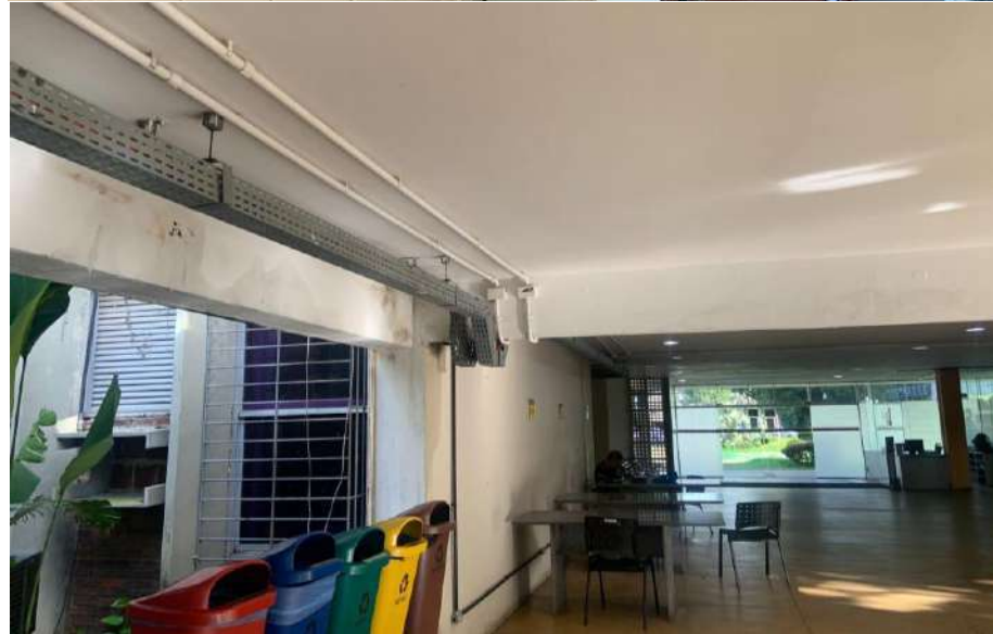
Imagens 04, 05 e 06 - Infiltração pela coberta no hall de acesso
