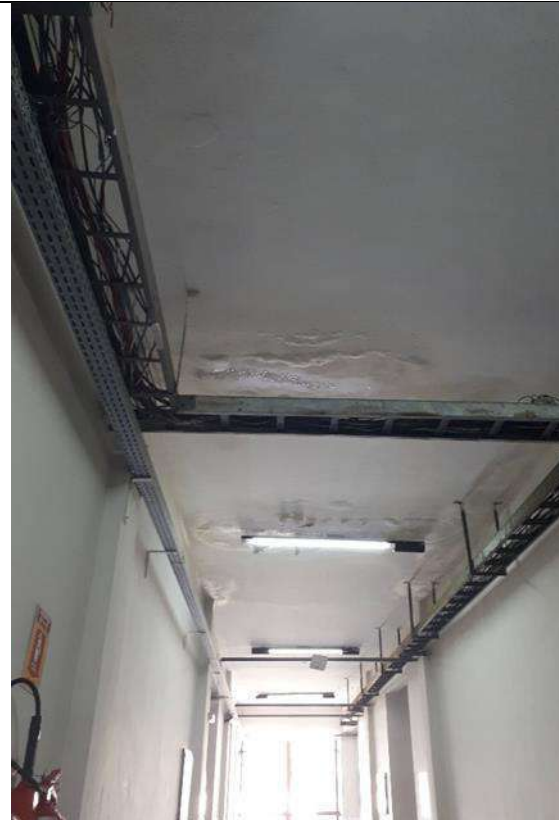
Vazamento corredor térreo
