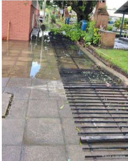
FOTO 02 - MURO DERRUBADO PELA CHUVA
