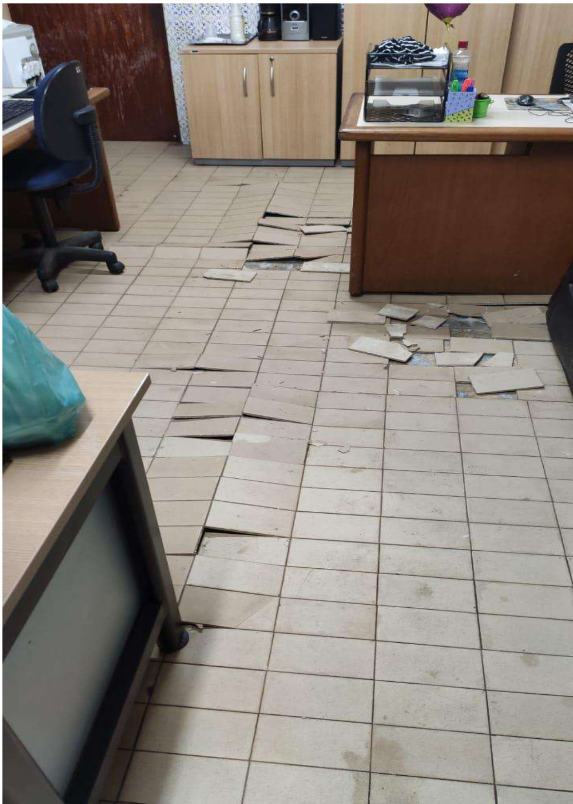
Figura 7. Piso danificado por alagamento (Apoio Acadêmico CCSA 1º pavimento)
