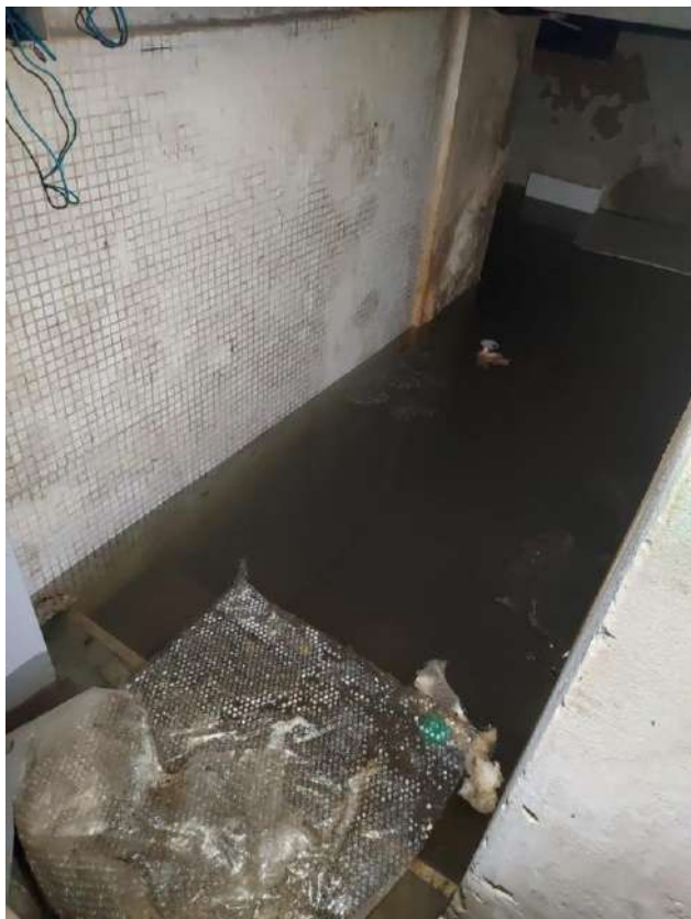
Lâmina de água acumulada no subsolo de aproximadamente 1,00m
