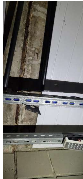
Junta de dilatação com muita umidade.
