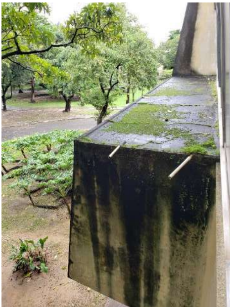
Foto 08: Laje impermeabilizada do Auditório em balanço, onde ocorre o pior vazamento no prédio.
