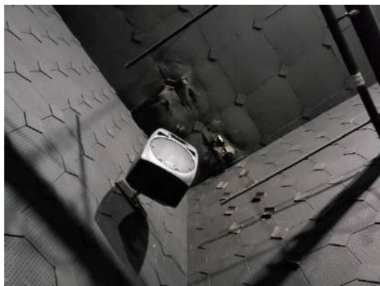
Foto 19: Forro acústico do Estúdio A danificado pelas infiltrações.
