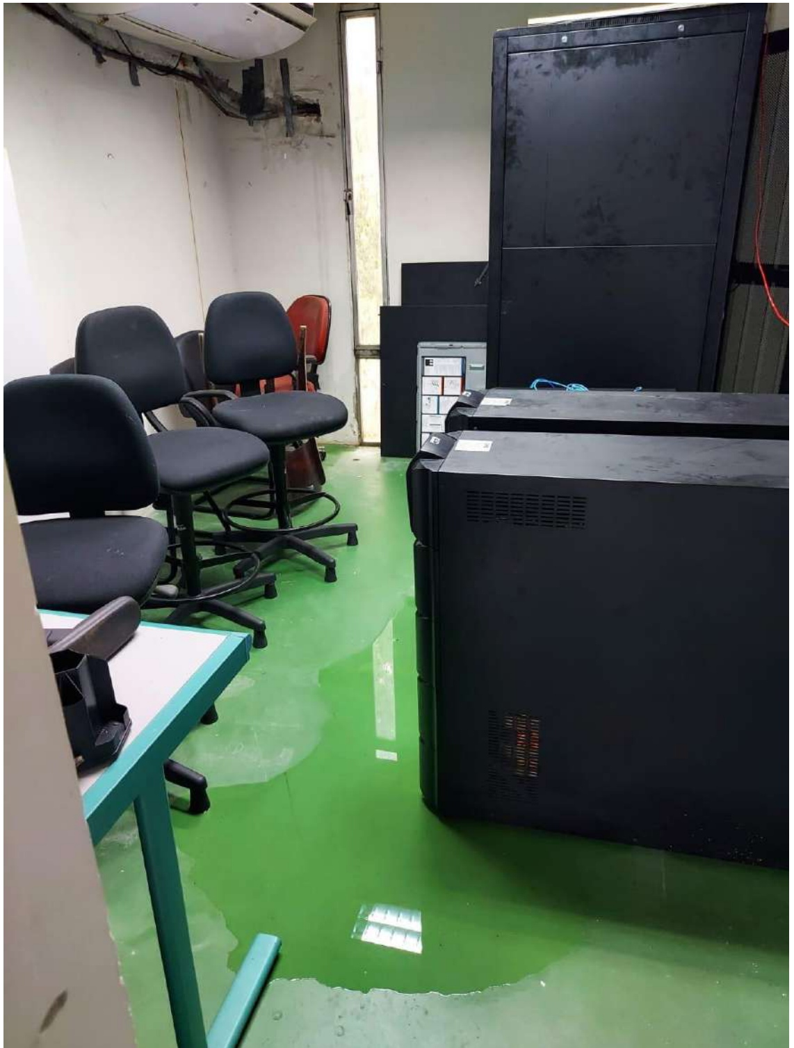
Água empoçada na sala do nobrake proveniente da esquadria
