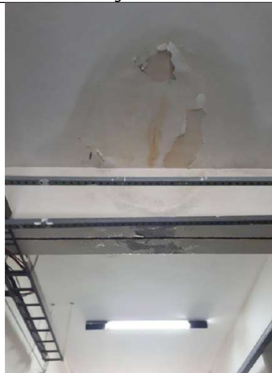
vazamento próximo a junta (Térreo)
