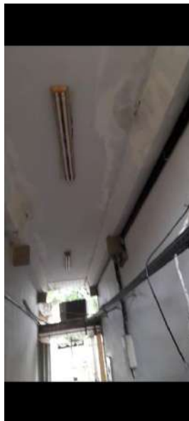
Foto 09 – Infiltração na circulação do Bloco E
