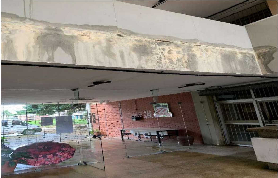
Figura 3. Infiltração no hall de entrada do Prédio do CAp
