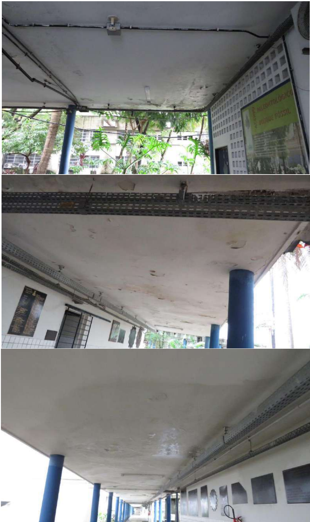
Figuras 1 a 10 - Alguns pontos de infiltração nas lajes das circulações térreas.
