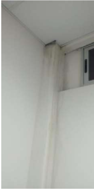
Infiltração pela estrutura;
