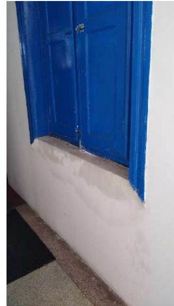
Infiltração pelas esquadrias do salão nobre
