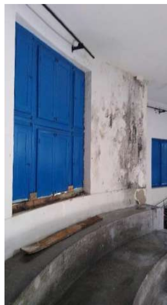
Anfiteatro com grande comprometimento do teto, paredes e esquadrias.
