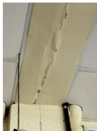
Junta de dilatação com infiltração.
