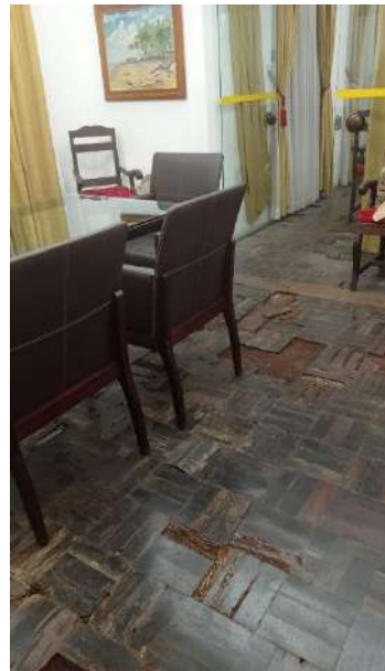
Toda a extensão do piso da academia Pernambucana de Medicina está completamente destruído por cupim.
