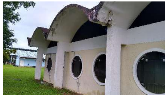
Coberta e estruturas necessitam revisão. Infiltração proveniente das calhas e muita infiltração por capilaridade proveniente do solo encharcado ao redor da Clínica.
