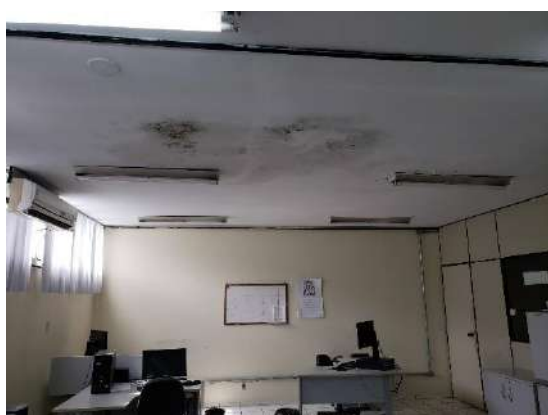
Foto 05: Vazamentos da cobertura na sala da Coordenação de Produção e Jornalismo.
