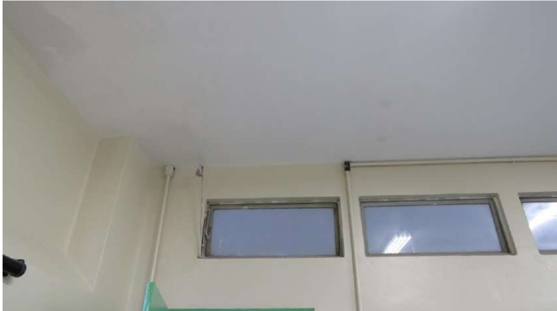
Figuras 22 a 24 - Infiltração na laje da Sala 08.
