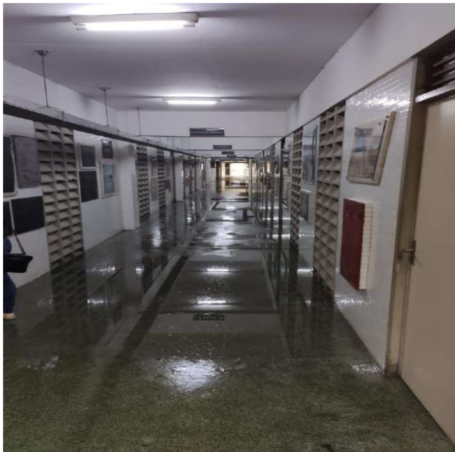
Figura 1. Piso alagado no corredor do Bloco C (CCSA)
