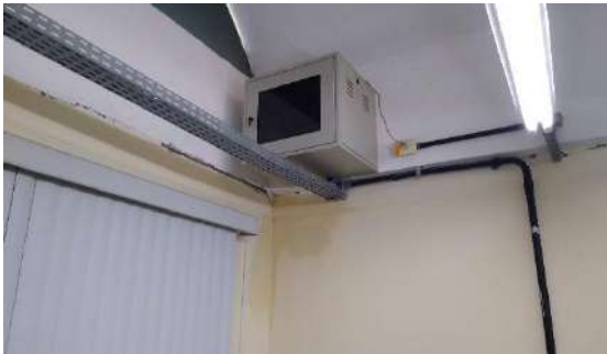
Infiltração próxima a rede elétrica.
