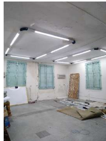
Sala de Ensaio - estado crítico, com bastante infiltração nas paredes e teto. Muito mofo.
