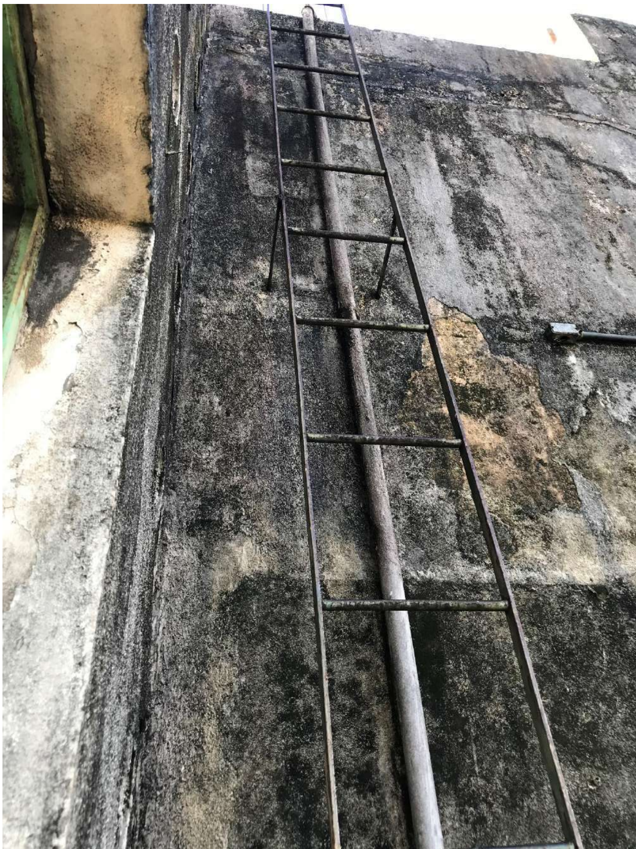
Figura 5. Parede externa com revestimento danificado (CCS)
