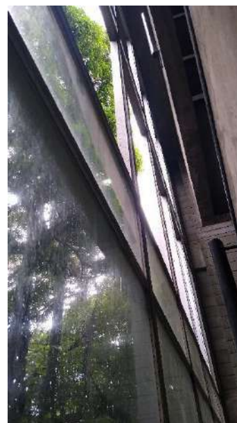
Esquadria da escada principal aberta, permitindo entrada de água das chuvas.
