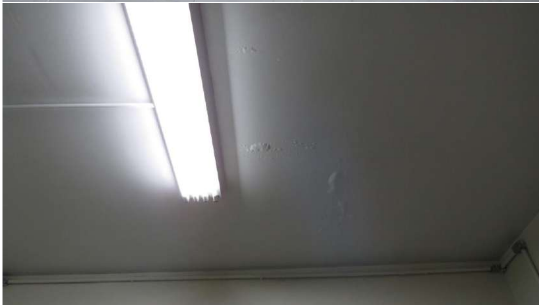
Figuras 3 e 4 - Infiltração na laje da escolaridade.
