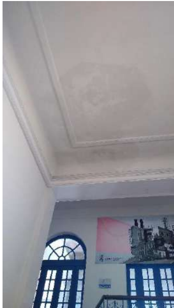
Infiltração no forro da escadaria central
