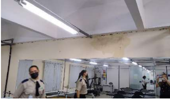
Infiltração proveniente da cobertura.
