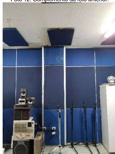
Foto 14: Vazamentos no Estúdio Transmídia da rádio, no último pavimento.
