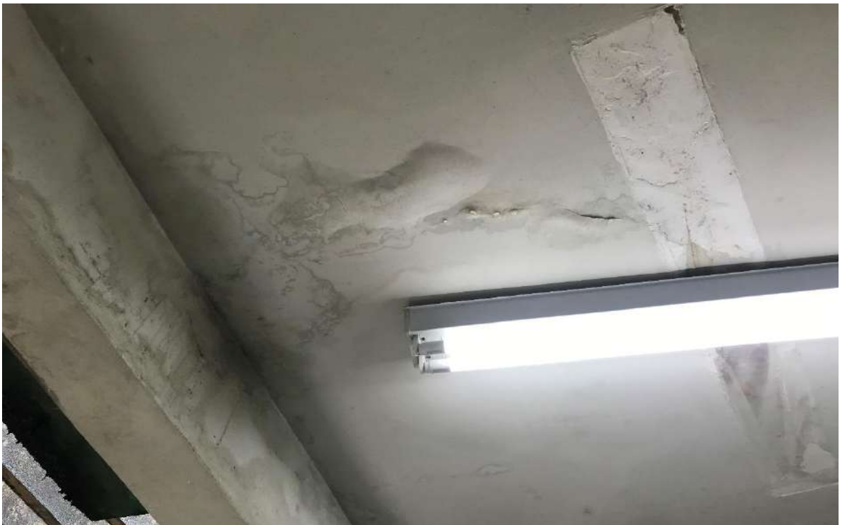
Figura 24. Infiltração em laje no Prédio Anexo de Anatomia CB
