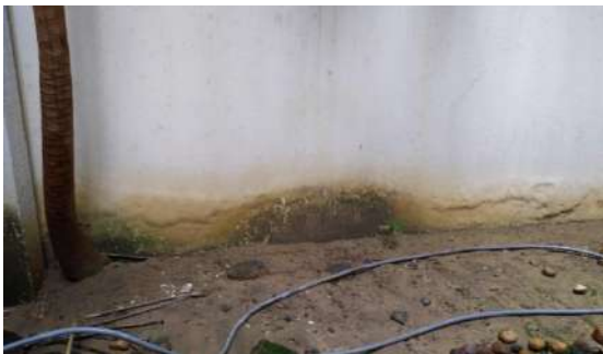
Impermeabilização do jardim de inverno ineficiente, com infiltração de água nas paredes por capilaridade.
