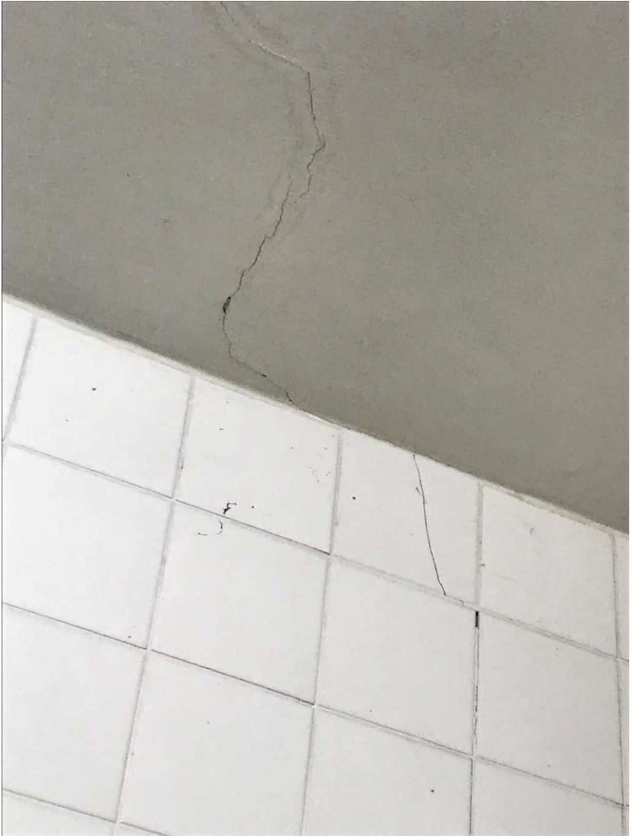
Figura 17. Rachadura em teto e parede da copa Prédio Anexo de Anatomia CB
