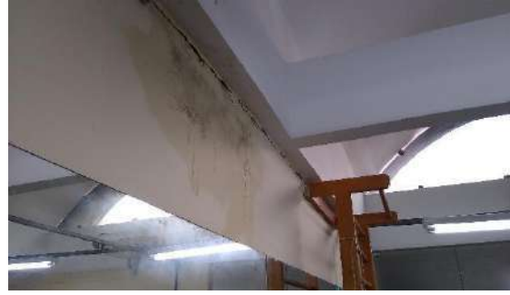
Infiltração proveniente da cobertura.
