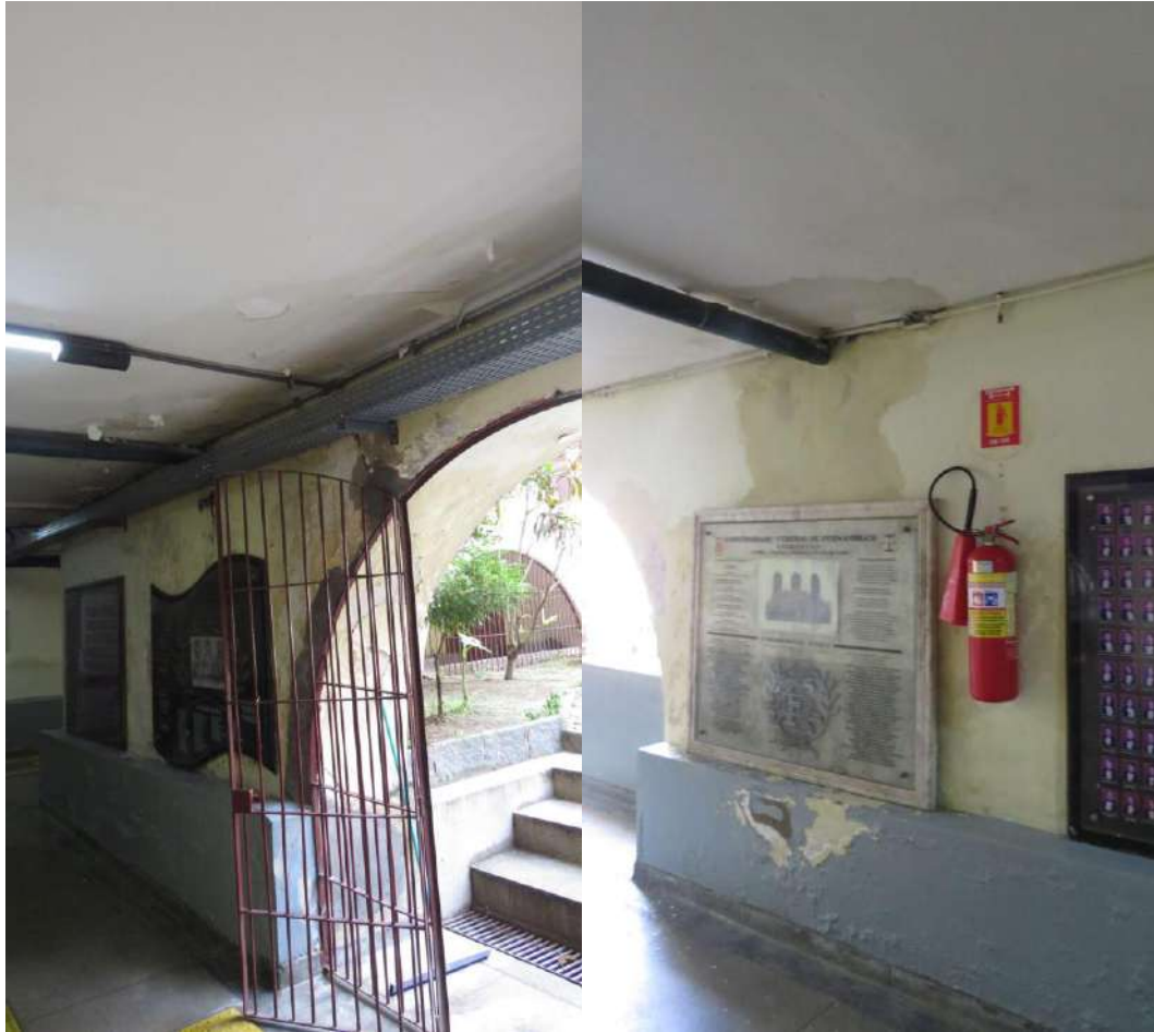
Figuras 32 a 37 - Alguns pontos críticos de infiltração na circulação do pavimento semi-enterrado.
