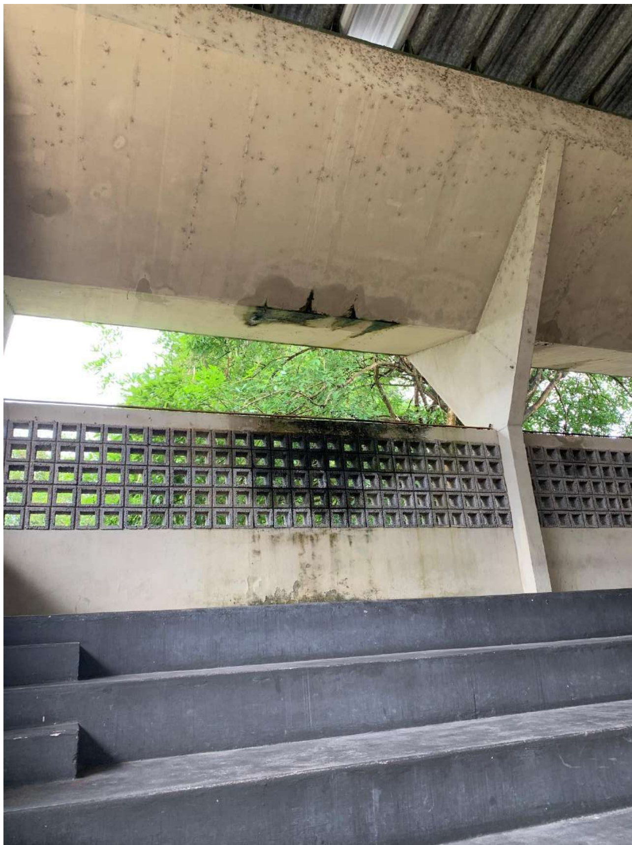
Figura 29. Vazamento em estrutura de drenagem na quadra de esportes CAP
