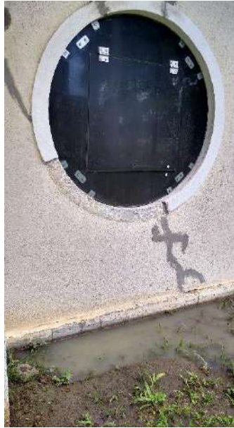
Muita água acumulada ao redor do edifício. Vista da fachada Norte.
