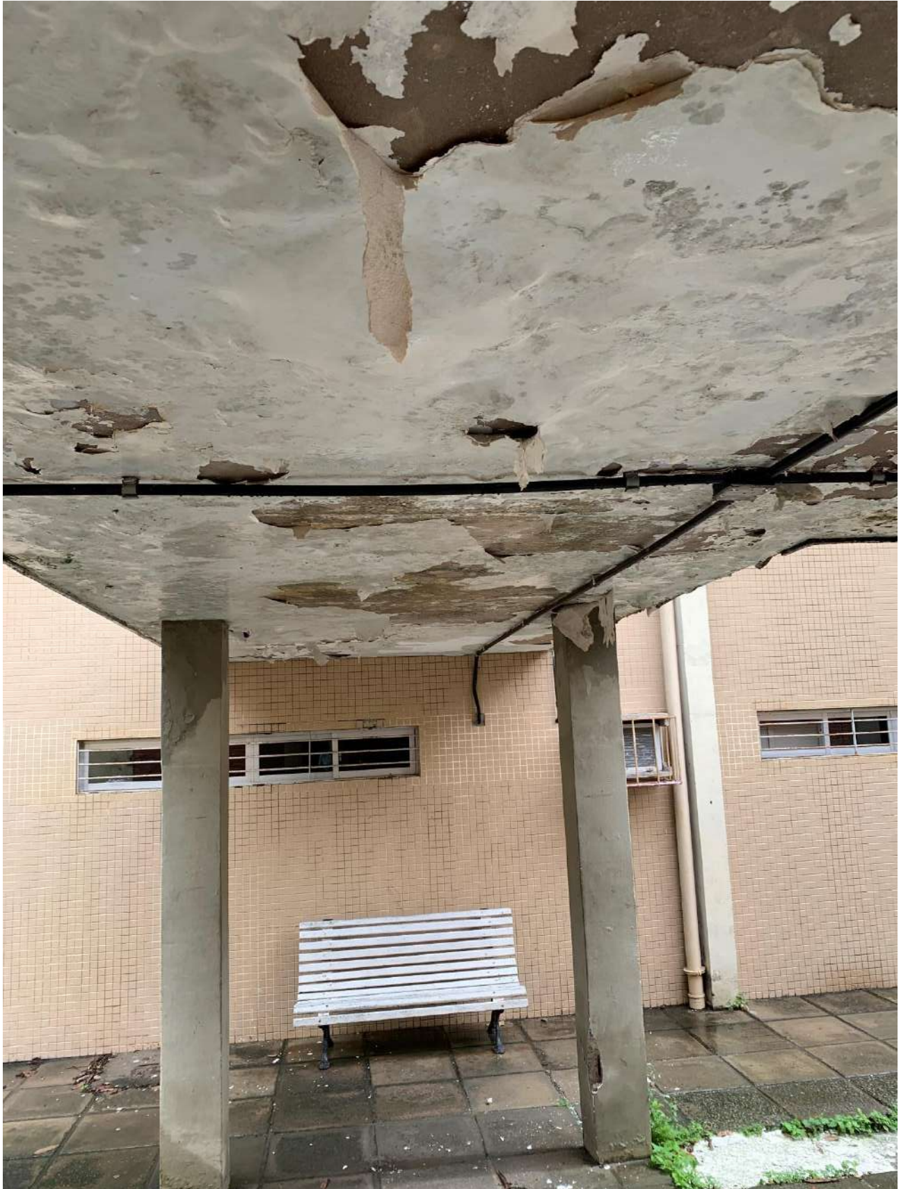
Figura 21. Infiltração em teto do passeio entre prédio principal e quadra de esportes CAp
