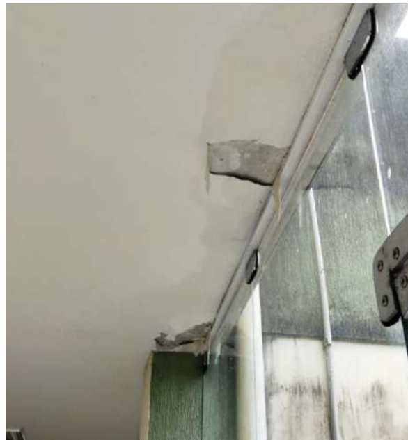
Figura 10: infiltração no forro da recepção
