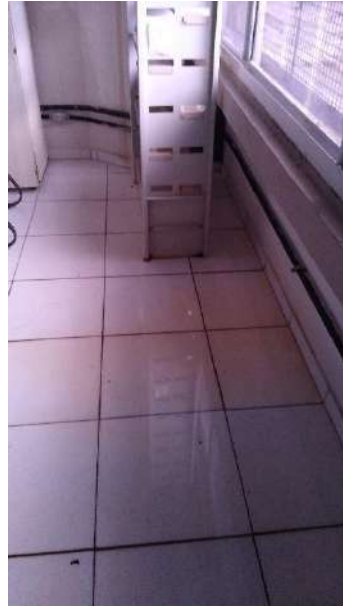
Biblioteca - sala da coordenação. Água empoçada no chão.
