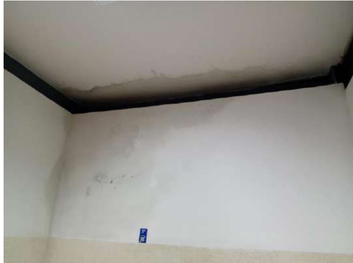
Figuras 1 a 8 - Infiltrações em lajes, paredes e junta de dilatação.
