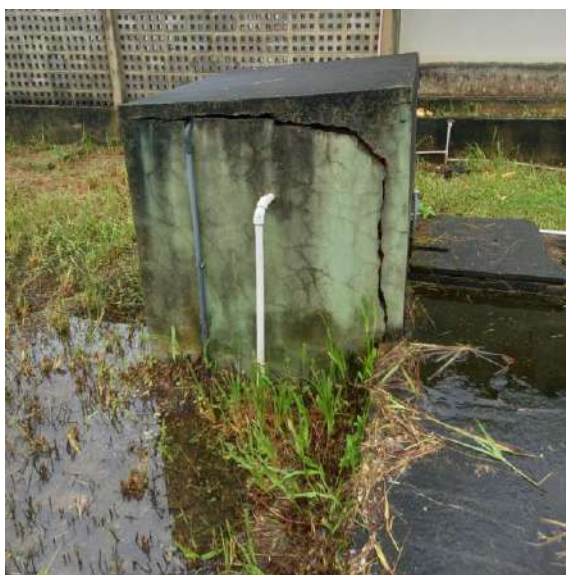
Figura 11: terreno alagado nas laterais e fundos da edificação; e rachadura na casa de bomba.
