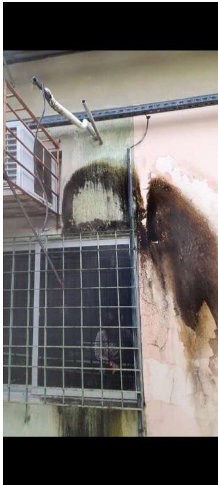
Foto 11 – Indícios de infiltração em parede do Centro de Materiais e Esterilização
