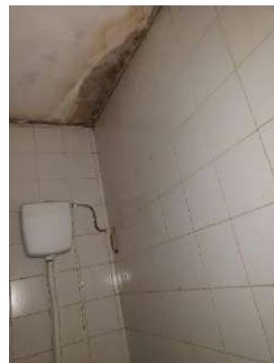
Foto 13: Infiltrações no banheiro da Sala de Aulas Práticas que fica localizada sob o Auditório.
