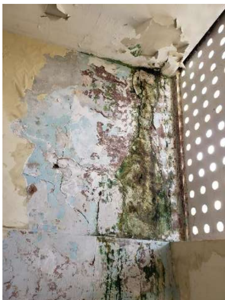
Foto 11: Infiltrações na caixa de escada.
