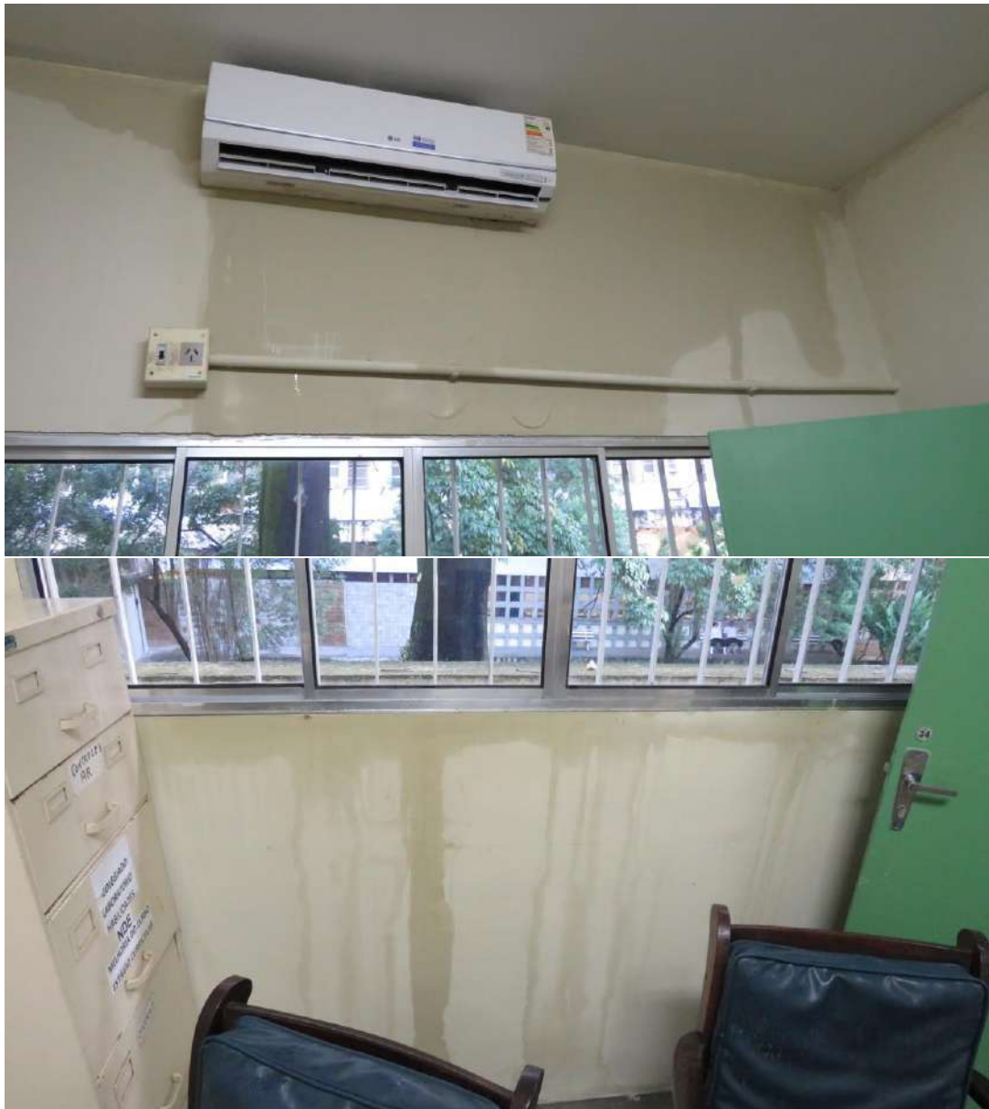
Figuras 5 e 6 - Infiltração na parede da Coordenação.
