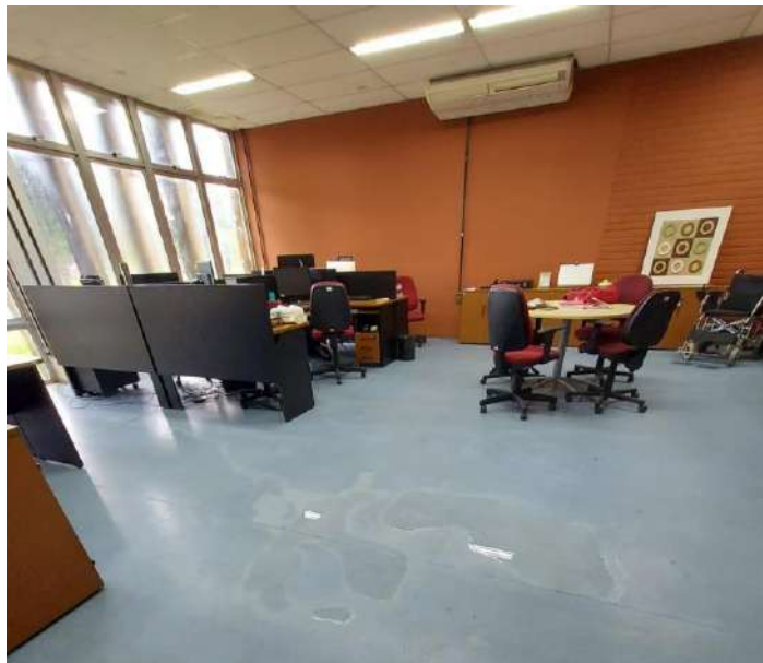
Água empçada proveniente da falha na vedação das esquadrias dealumínio comprometendo pisos e forros
