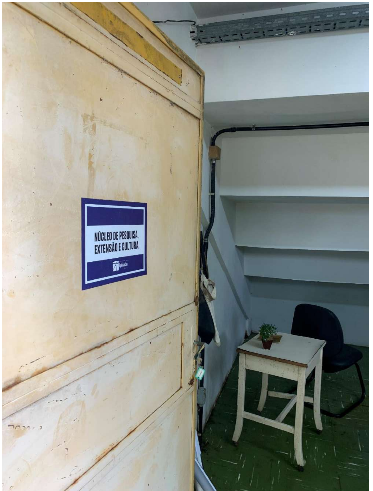
Figura 34. Salas administrativa abaixo da quadra de esportes com acúmulo de águas de chuvas CAp
