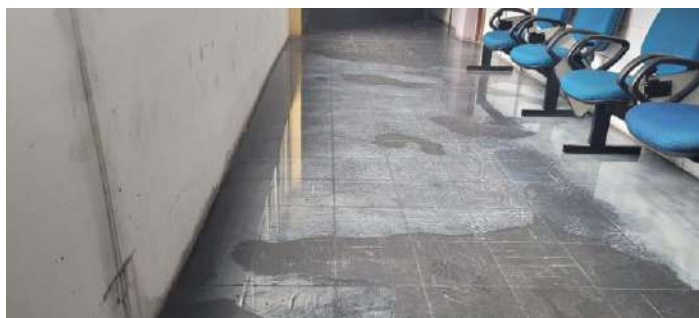
Alagamento no piso em diversos pontos da circulação.
