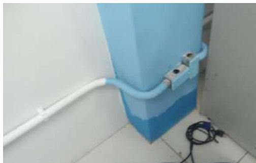
Infiltração por capilaridade na estrutura. Próximo a instalações elétricas.
