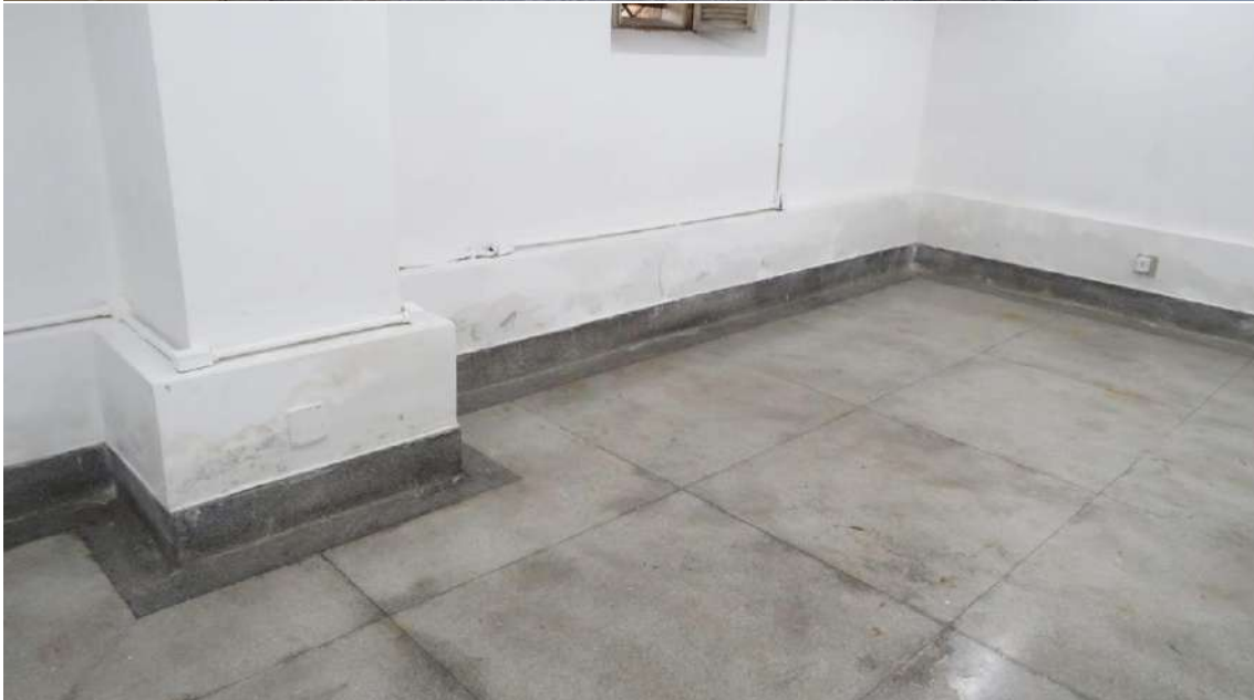
Figuras 2 a 19 - Alguns pontos críticos de infiltrações nas salas do pavimento semi-enterrado.
