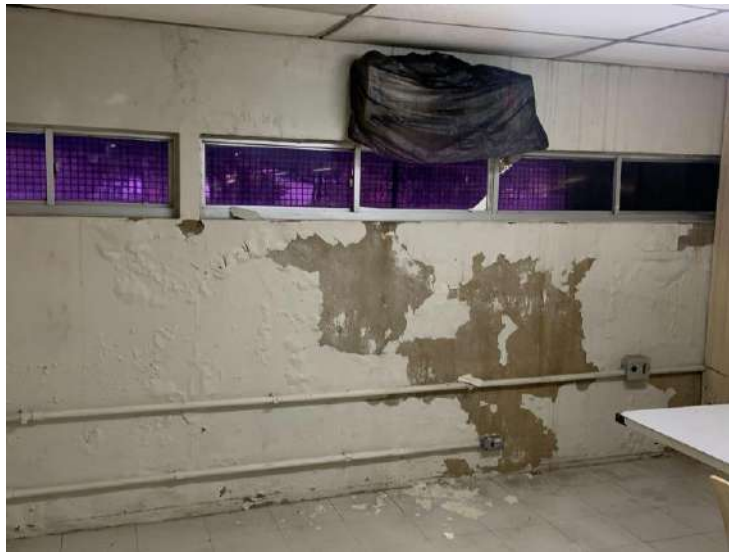
Imagem 16 - Ambiente Sala 12 com manifestações patológicas devidas a umidade
