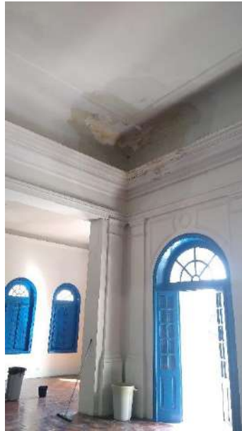
Infiltração em vários pontos do teto do salão nobre
