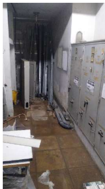
Sala de alta tensão com lâmina d'água em todo piso. Perigo de choque elétrico.
