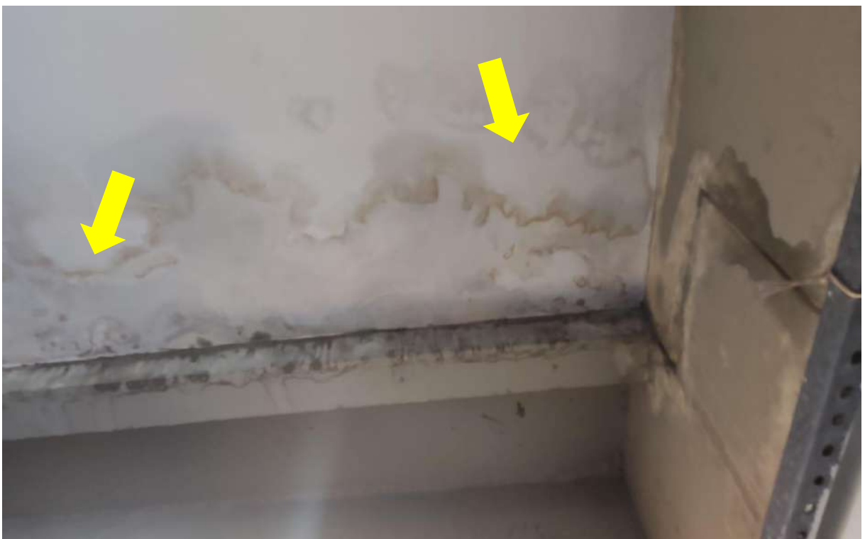
Figura 20. Vazamentos no teto da Rádio Universitária (Sala de Apoio)
