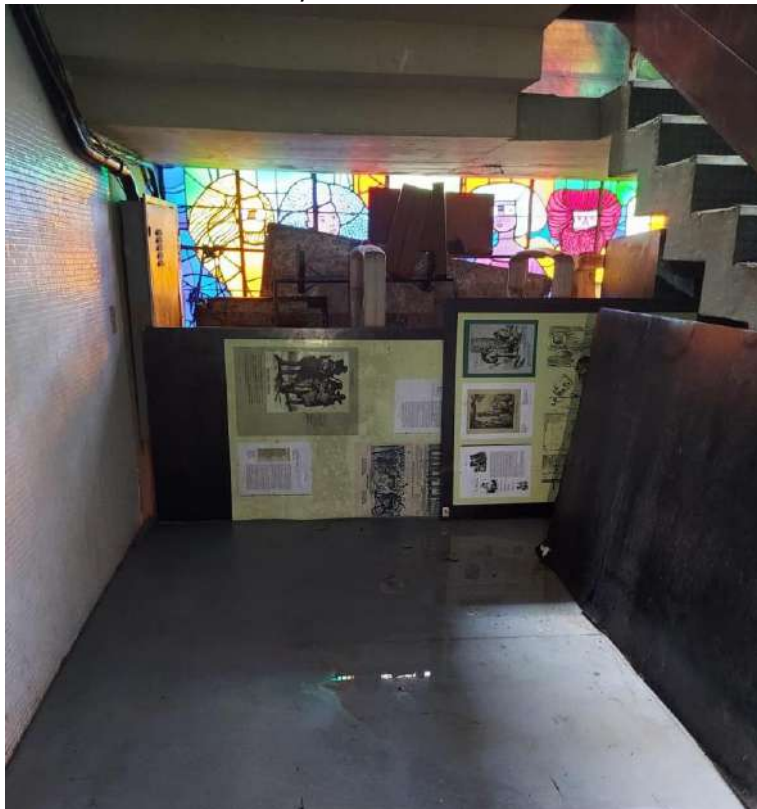
Água empogada no piso proveniente das aberturas do vitral
