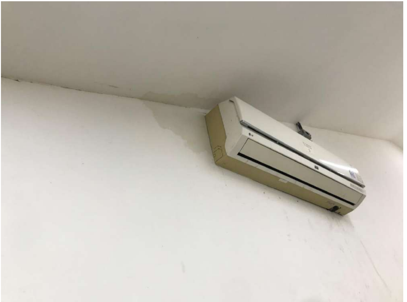
Figura 7. Infiltração na laje no Anfiteatro no 2º Pavimento próximo ao SVO (CCS)
