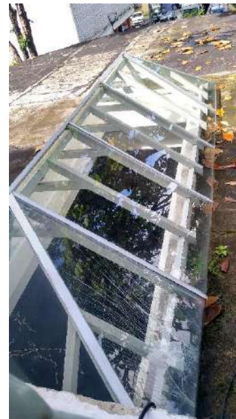
Clarabóia com vidro danificado - alto risco à segurança.
