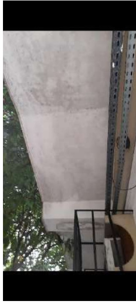
Foto 08 – Infiltração na cobertura do bloco E
