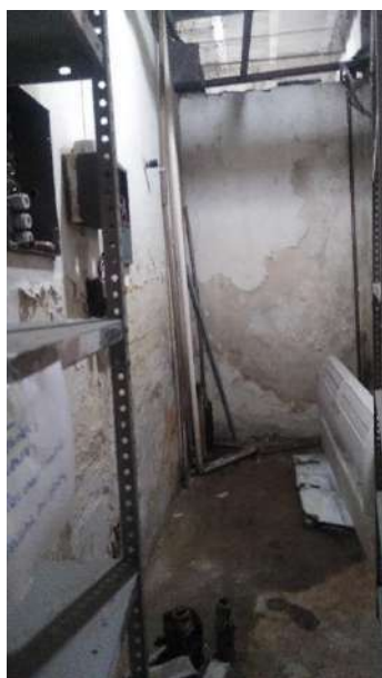
Antiga central de ar condicionado com água no piso e vários pontos de infiltração.
