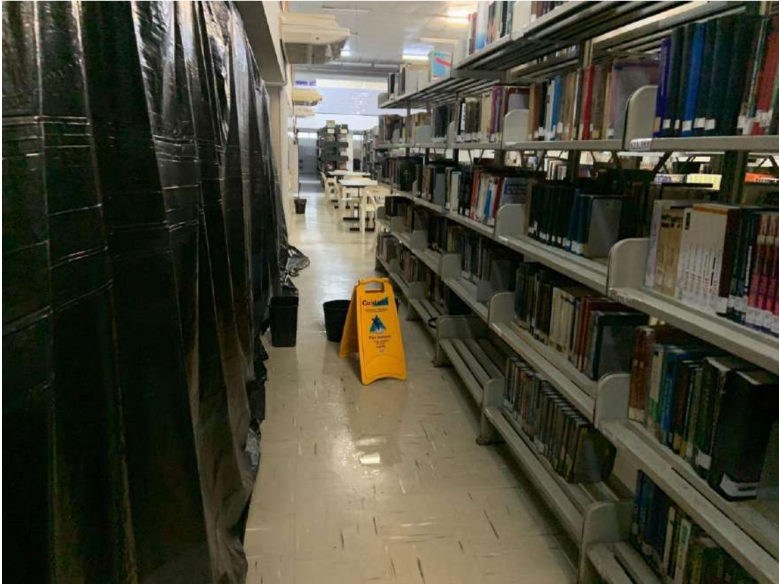
Imagem 07 - Pontos de acúmulo de água e lona improvisada para proteção do acervo
