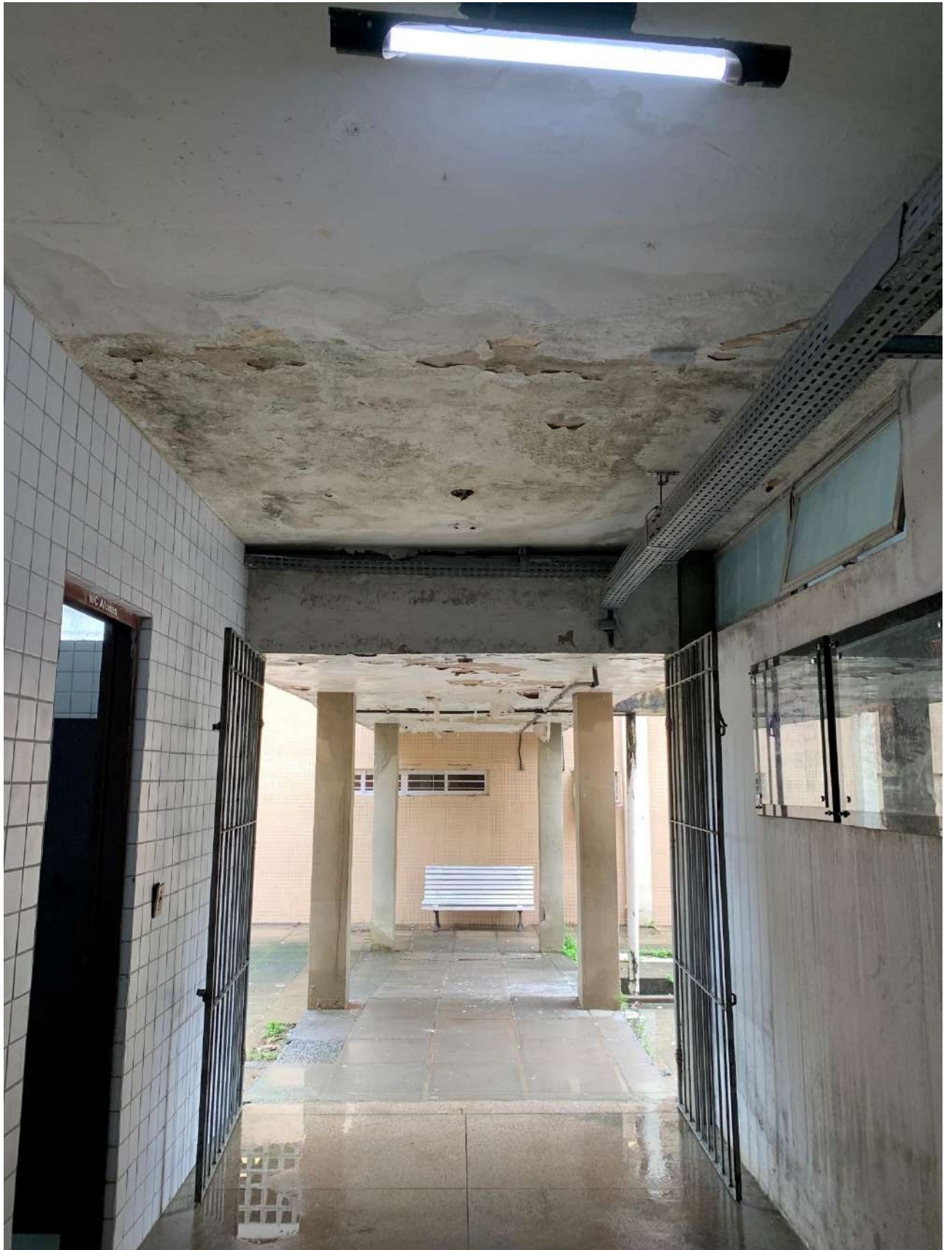
Figura 25. Infiltração no teto no 1º pavimento CAP
