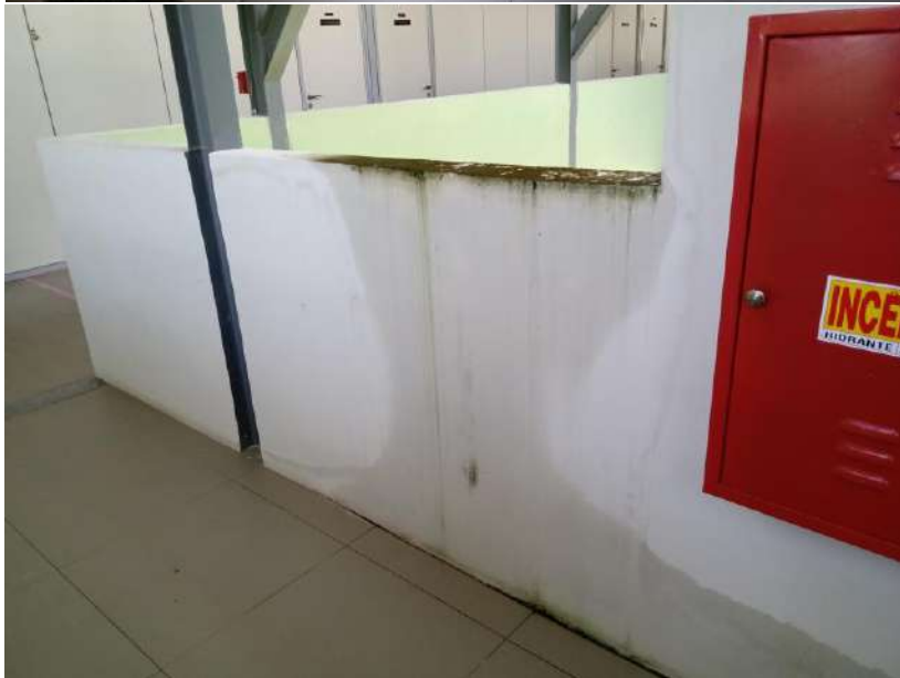
Figuras 9 e 10 - Acúmulo de água no pavimento devido aos vãos acima dos guarda-corpos.
