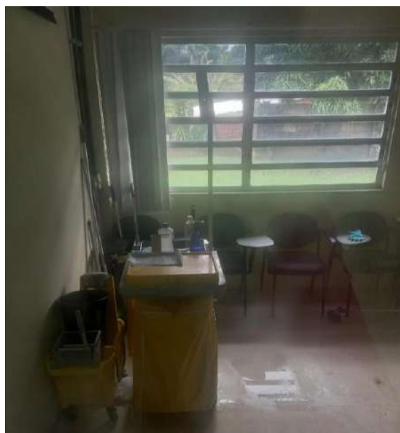
Figura 2: infiltração na Sala de Serviço Social.
