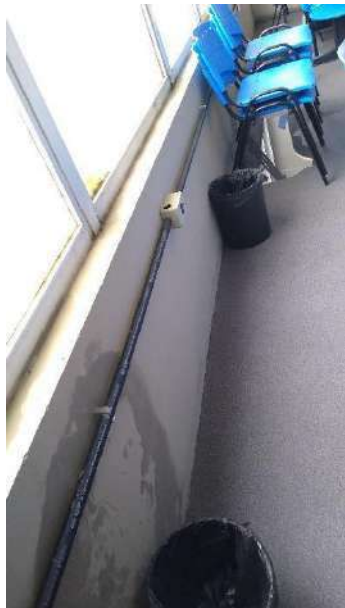
Biblioteca. Infiltração nas esquadrias e paredes do salão principal.
