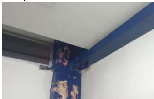
Muita infiltração pela estrutura e umidade em grande parte das salas.
