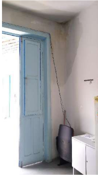
Sala da coordenação. Infiltração na parede, proveniente da coberta.
