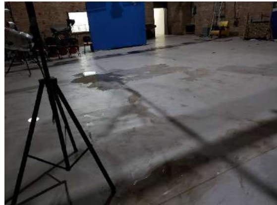
Foto 18: Vazamentos advindos das telhas danificadas sobre o Estúdio B, estragando o piso em manta vinílica.
