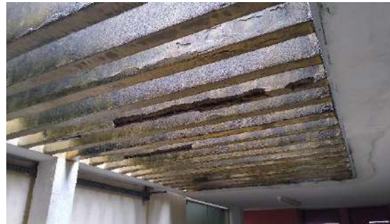
Pergolado com infiltração e ferrugem aparente, comprometendo a sua integridade.
