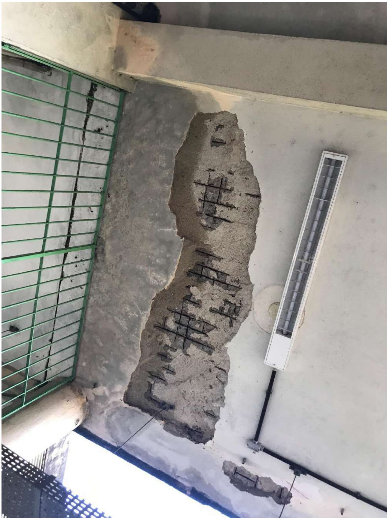
Figura 4. Infiltração na laje provocando a desagregação do reboco (Depto Anatomia 3º Andar)
