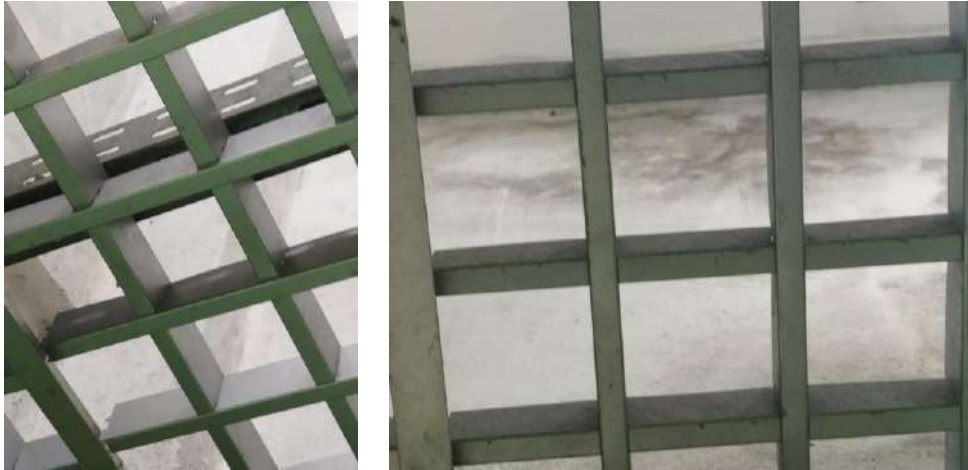
Figuras 5 e 6: infiltração nas paredes dos WC's ao lado da Recepção.
