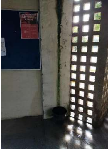
Infiltração pela junta de dilatação (térreo)
