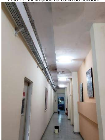
Foto 13: Infiltrações advindas da cobertura no último pavimento.
