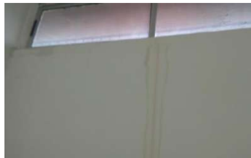
Infiltração pelas esquadrias.
