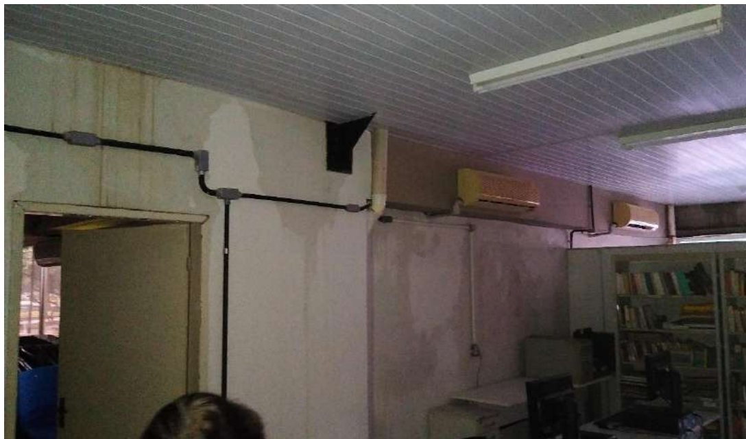
Biblioteca - Sala da coordenação. Muita infiltração.
