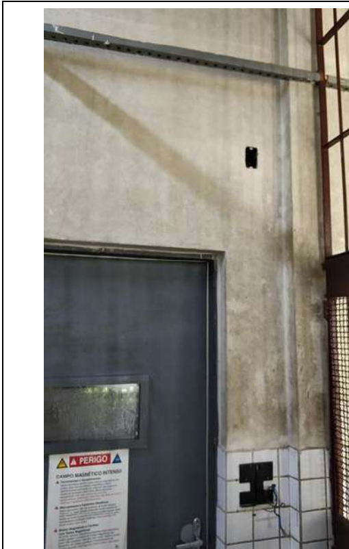
Figura 4: Umidade e mofo nas paredes
