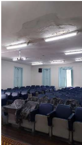
Auditório 3, 1º andar. Muita infiltração no teto, comprometendo as luminárias
