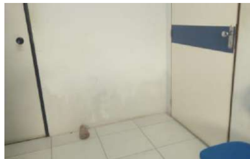
Infiltração por capilaridade. Salas de aula com água empoçada no piso.
