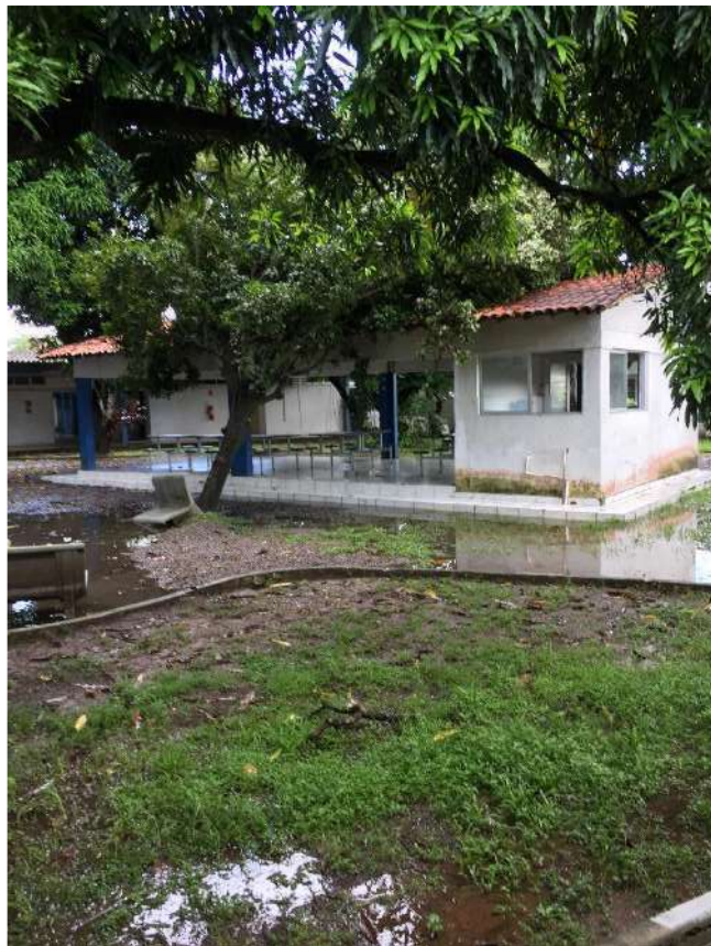
TETO CANTINA(QUEDA DE ÁRVORE)
