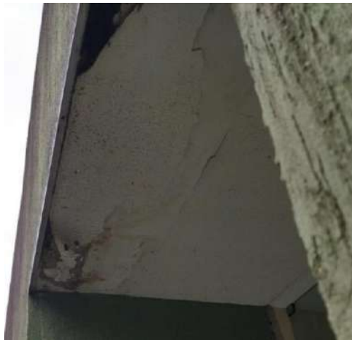
Figura 7: Infiltração no teto do acesso lateral.
