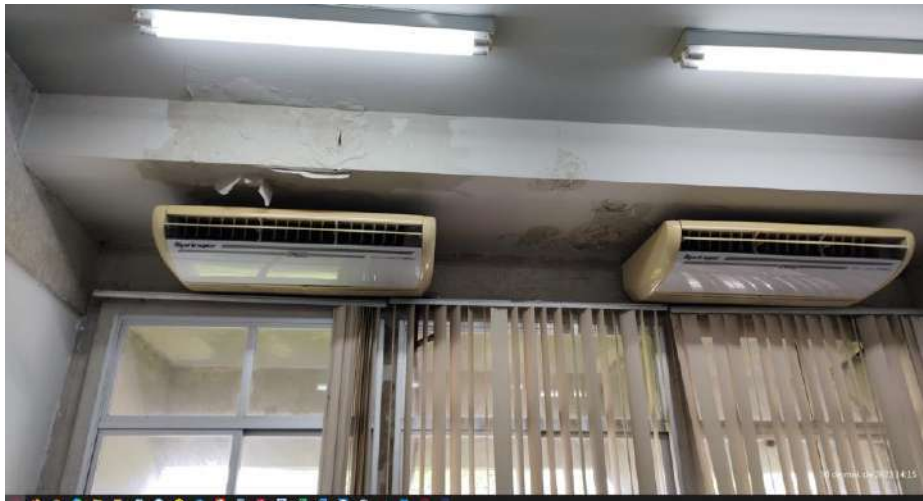
FOTO 09 SALA COM INFILTRAÇÃO NA CALHA
