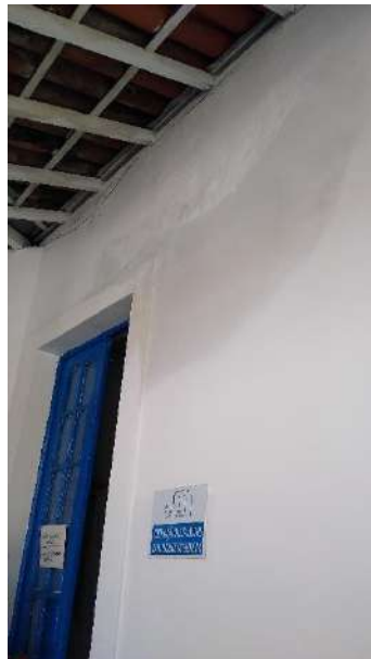
Infiltração paredes do corredor central
