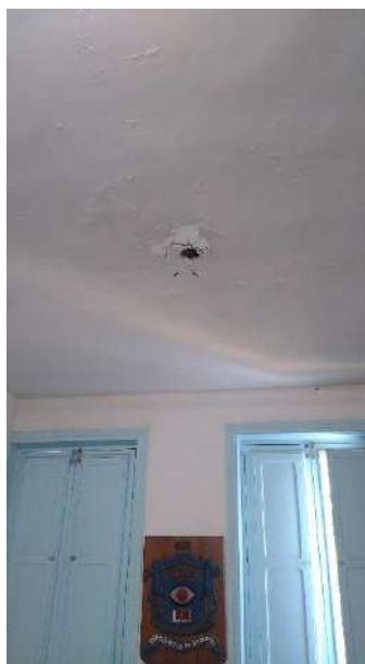
Academia de Artes e Letras - Infiltração no ponto de energia, comprometendo a segurança.
