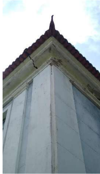
Rachadura na fachada. Esta quina é onde está localizada a coordenação, um dos pontos mais críticos de infiltração.
