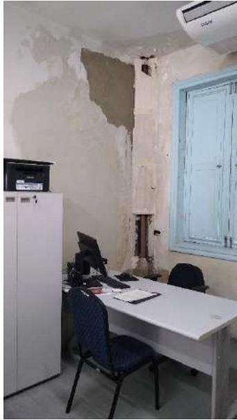
Sala da coordenação. Canto da sala com tubulação exposta e risco de queda das placas de gesso que encobrem a tubulação
