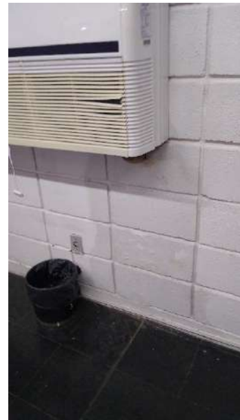
Biblioteca. Bastante infiltração nas paredes da fachada leste.
