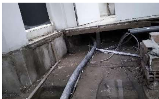
Piso falso de sala que está em reforma no pavimento térreo. Água acumulada no solo
