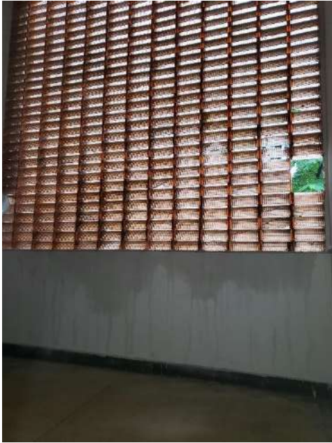
Foto 06: Cobogós em vidro danificados por onde passam, e infiltram, as águas nos patamares das escadas.
