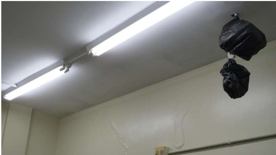
Figuras 9 a 12 - Infiltração na laje e parede do Laboratório de Informática da Pós.
