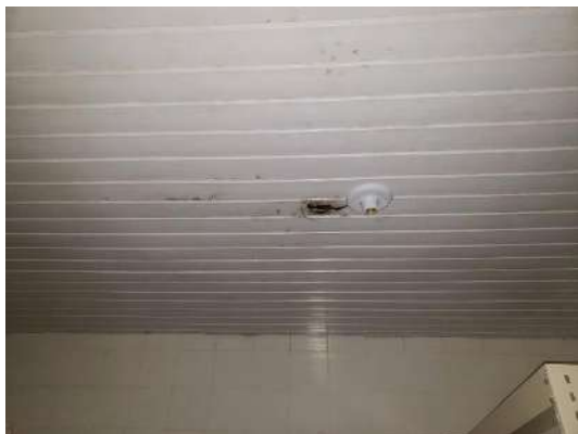
Foto 26: Pequenos vazamentos dentro do Biotério do Departamento de Antibiótico.
