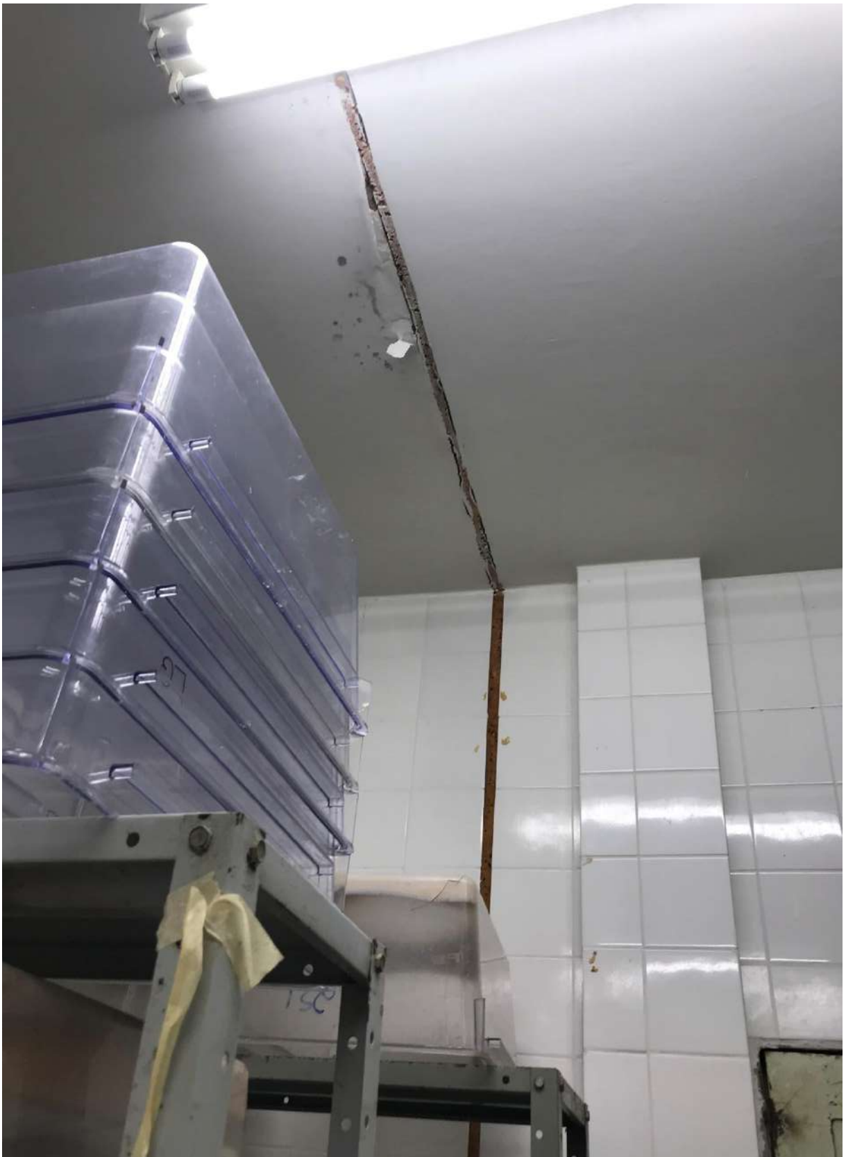
Figura 30. Junta de dilatação com falhas na vedação Prédio Anexo de Anatomia
