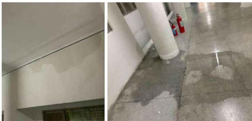
Imagens 06, 07, 08, 09 e 10 - Umidade em superfícies no 1º pavimento
