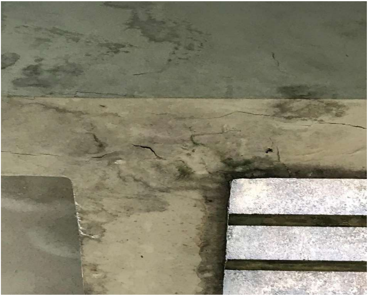
Figura 13. Rachaduras e infiltração no Prédio Anexo de Anatomia CB
