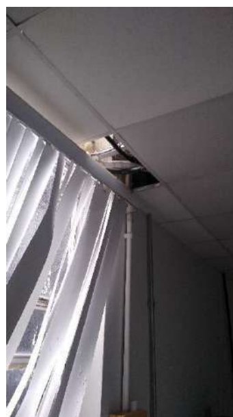
Em vários pontos, verifica-se gotejamento das instalações de ar condicionado, com indício de condensação nas tubulações.
