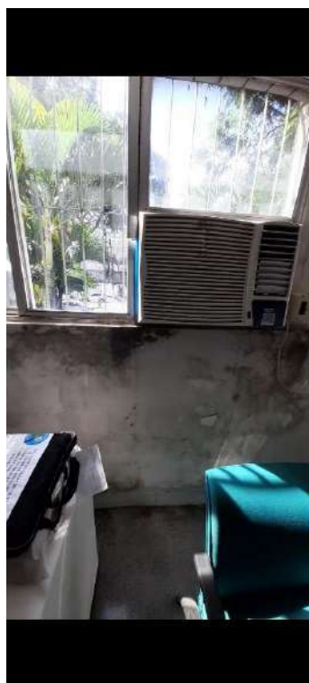
Foto 05 – Infiltração na parede da secretaria do departamento
