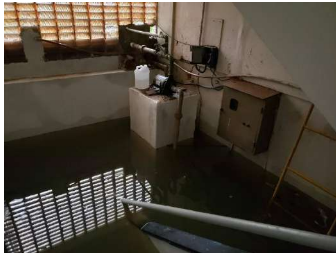
Foto 03: Bomba de recalque do reservatório inferior e quadro de distribuição elétrica, no subsolo.
