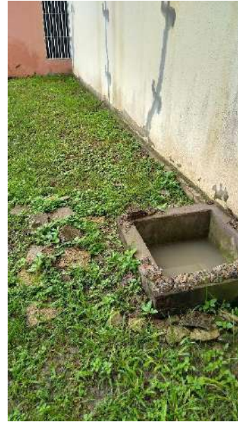
Muita água acumulada ao redor do edifício. Vista da fachada Sul.
