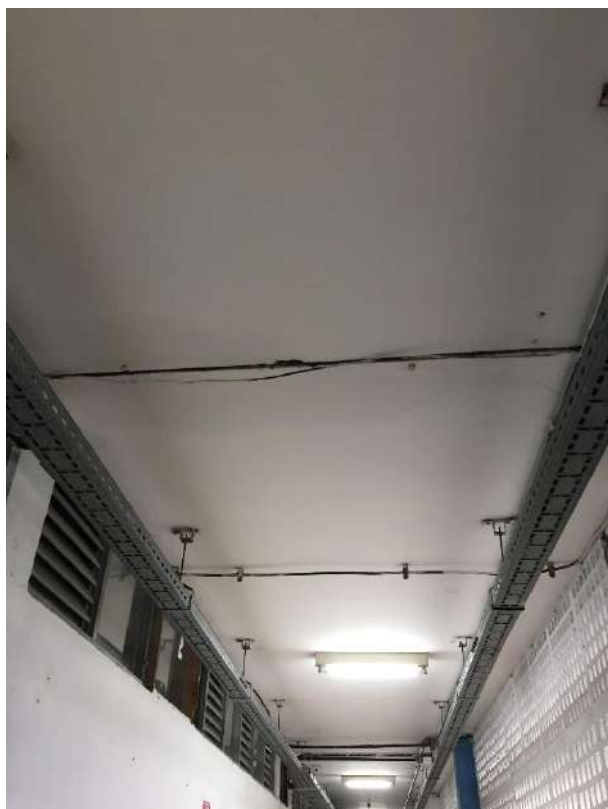
TETO DO CORREDOR PRÓXIMO A RECEPÇÃO - COM JUNTA DE DILATAÇÃO E VAZAMENTO
