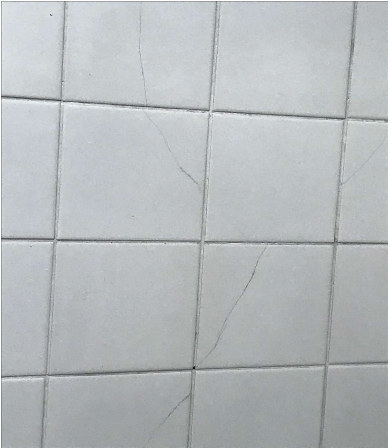
Figura 16. Rachadura em parede da copa Prédio Anexo de Anatomia CB
