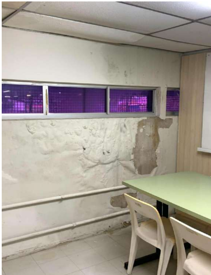
Imagens 13, 14 e 15 - Ambiente Sala 13 com manifestações patológicas devidas a umidade
