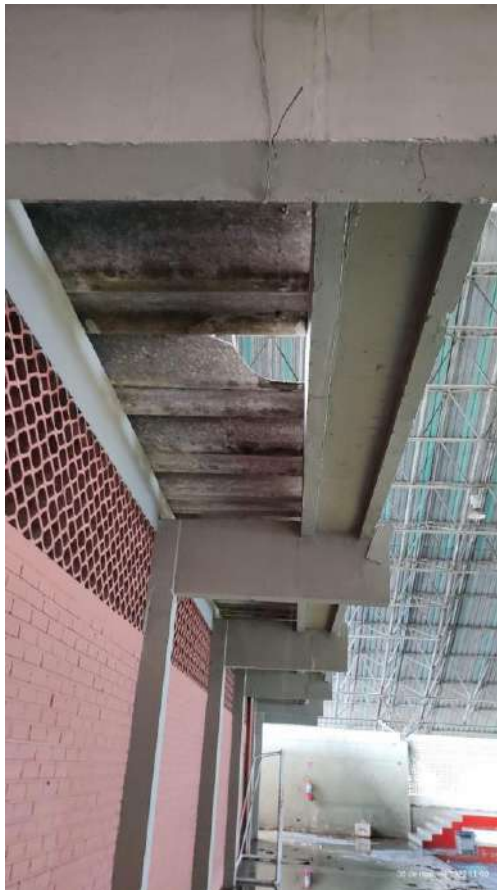
FOTO 03 - TRECHO DA COBERTA DANIFICADO
