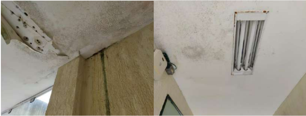
Figuras 8 e 9: infiltração no forro da circulação.
