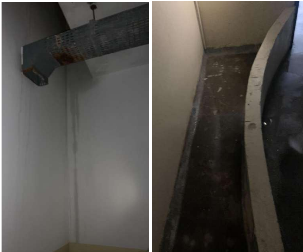
Imagens 15 e 16 - Infiltrações através de jardineira na circulação de um dos pavimentos
