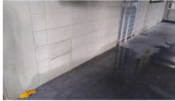
Água proveniente do jardim central invadindo corredores laterais do térreo e infiltrando nas paredes.
