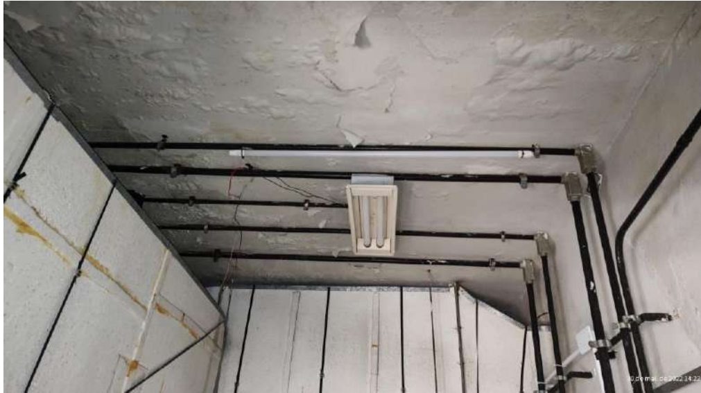
FOTO 02 SALA DO AR-CONDICIONADO CENTRAL
