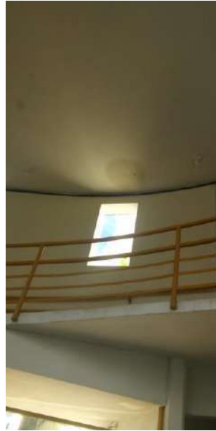
Infiltração no teto do Hall de acesso principal.
