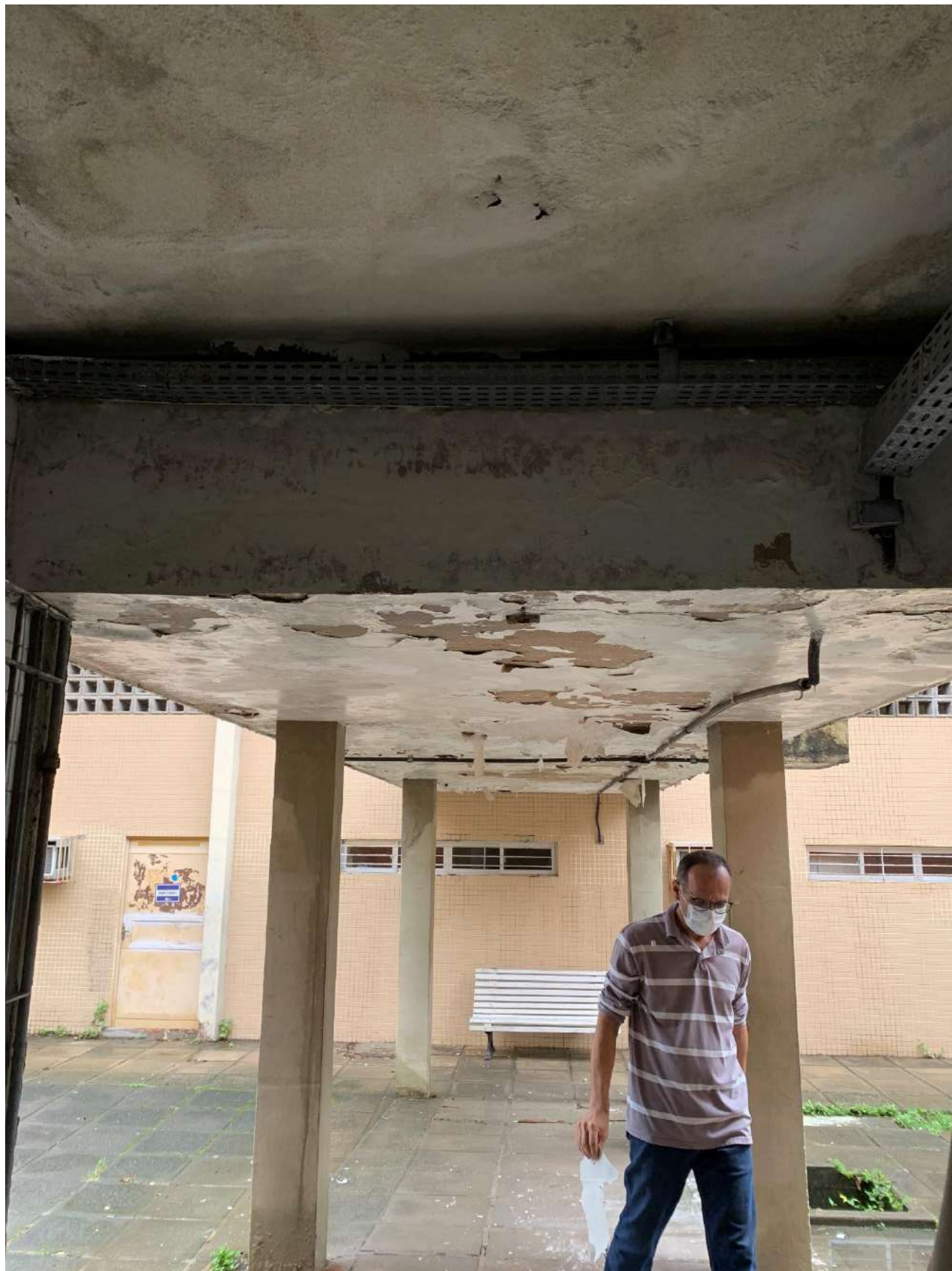
Figura 20. Infiltração em teto do passeio entre prédio principal e quadra de esportes CAp
