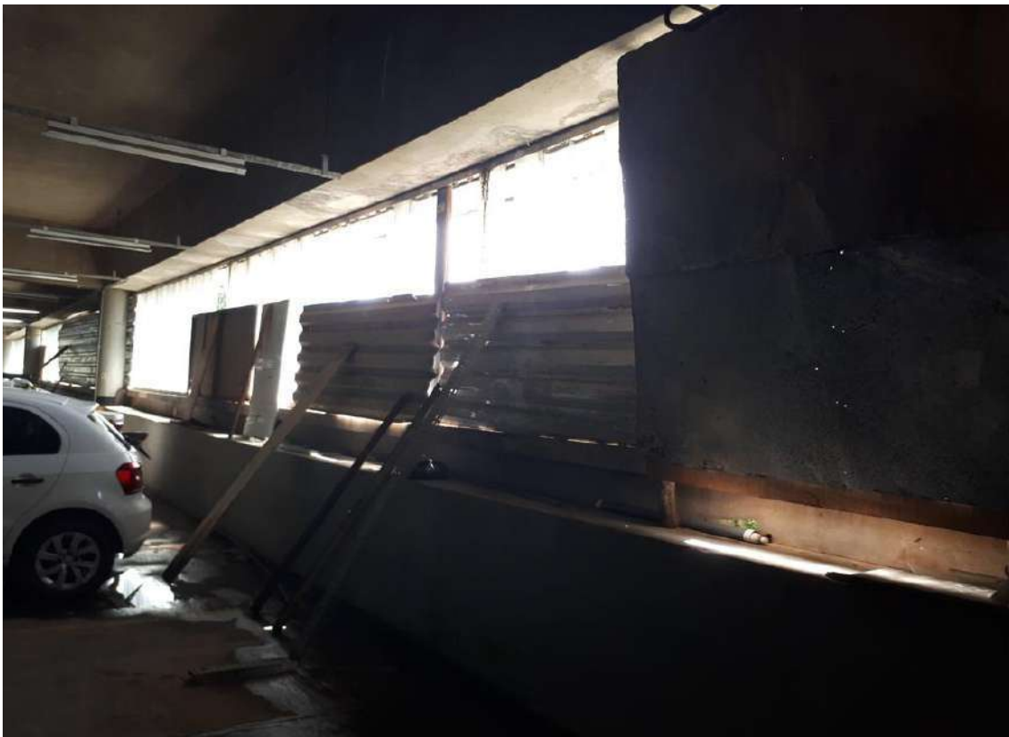
falta dos vidros que compõem a fachada facilitou a entrada de água
