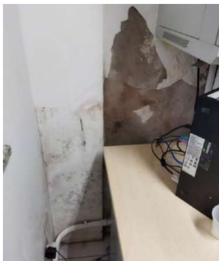
Figura 4: Infiltração da parede da Coordenação Administrativa (provavelmente causada pelo encanamento do WC Feminino)
