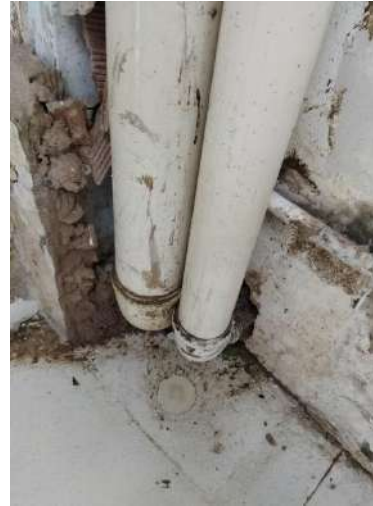
Parte inferior da mesma tubulação que está exposta na sala de aula
