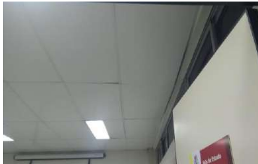
Infiltração proveniente da cobertura. Forro Drywall com acúmulo de água (1º andar)
