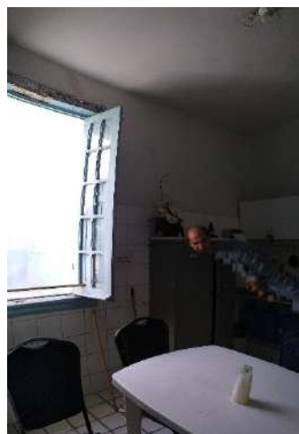
Copa. Infiltração nas paredes e teto. Verga da janela com ferragem aparente.
