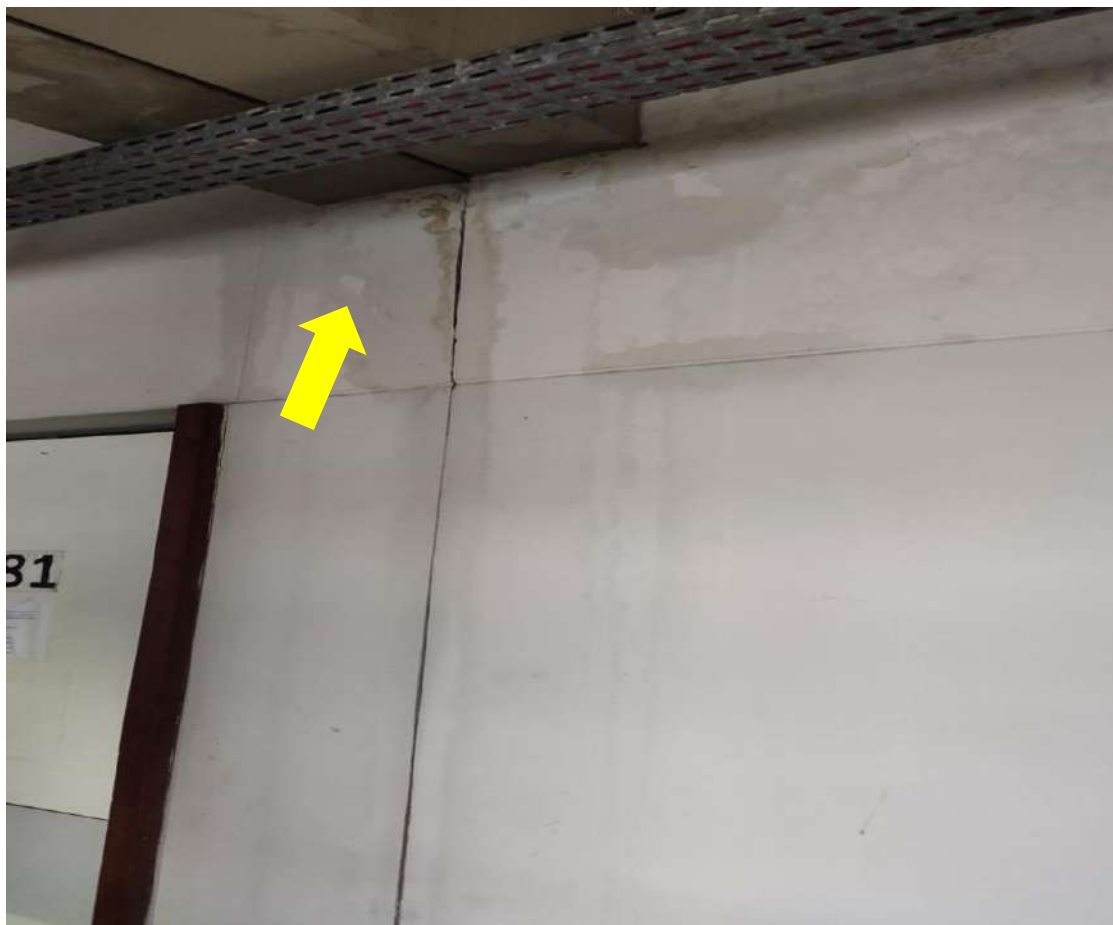
Figura 15. Infiltração no teto no Prédio da Reitoria (DCF - PROPLAN térreo)
