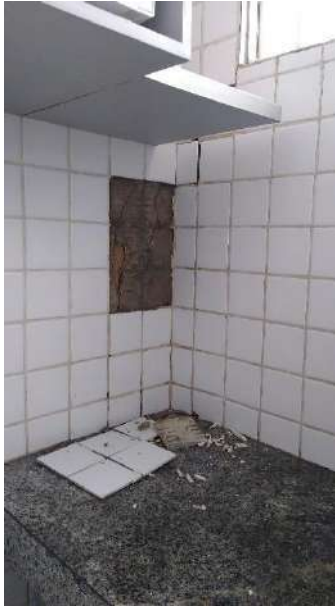
Infiltração pelo pilar, com descolamento do revestimento interno.
