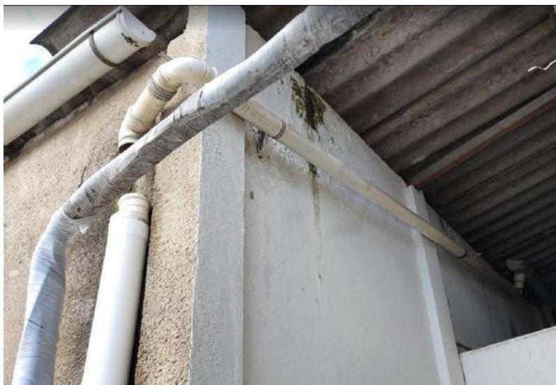
FOTO 10 – COLETA DE ÁGUA DE CHUVAS DESCONECTADO
