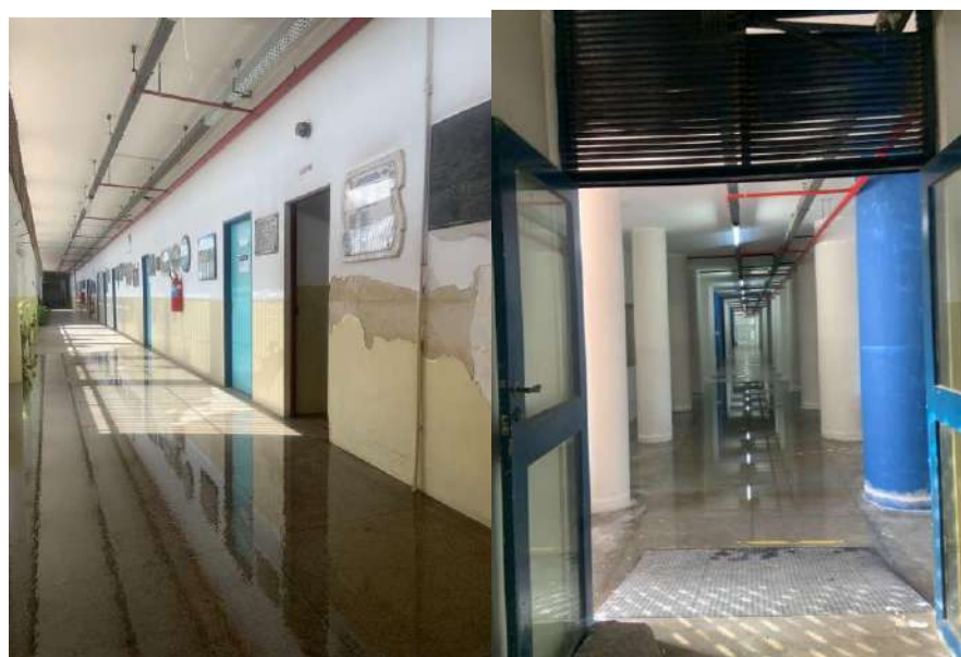
Imagem 11, 12 e 13 - Nível de acúmulo de água em ambientes de circulação de diferentes pavimentos
