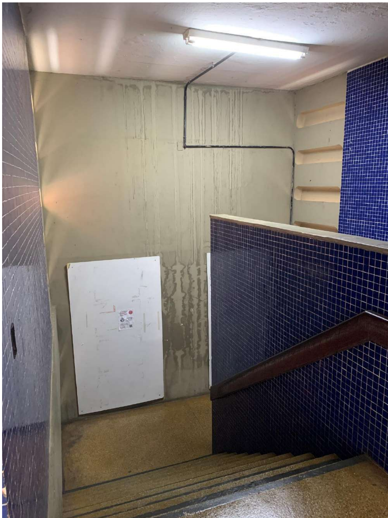
Figura 6. Infiltração na escadaria de acesso ao 2º pavimento CAp
