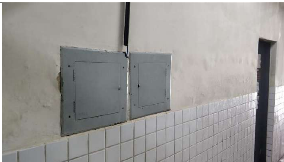
Figura 2: Umidade corredor térreo
