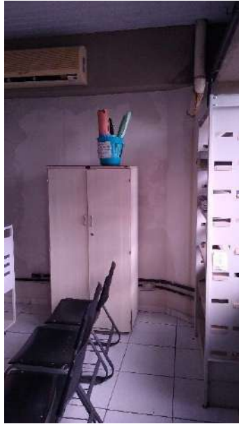
Biblioteca - sala da coordenação. Bastante infiltração nas paredes. Tubo de queda por dentro da sala, com gotejamento.
