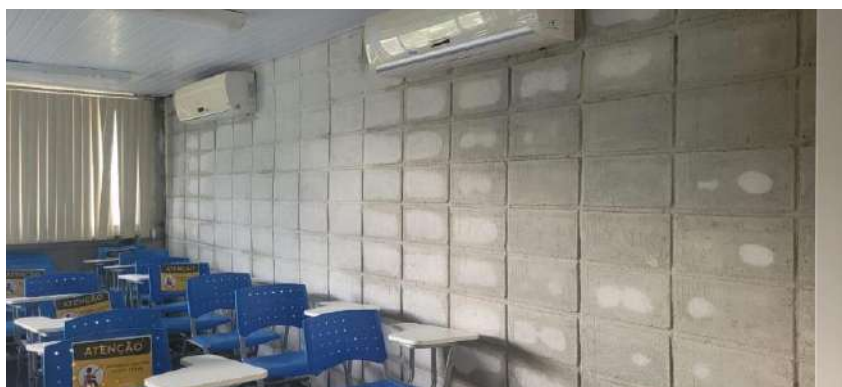
Muita umidade nas paredes em sala de aula do mezanino.
