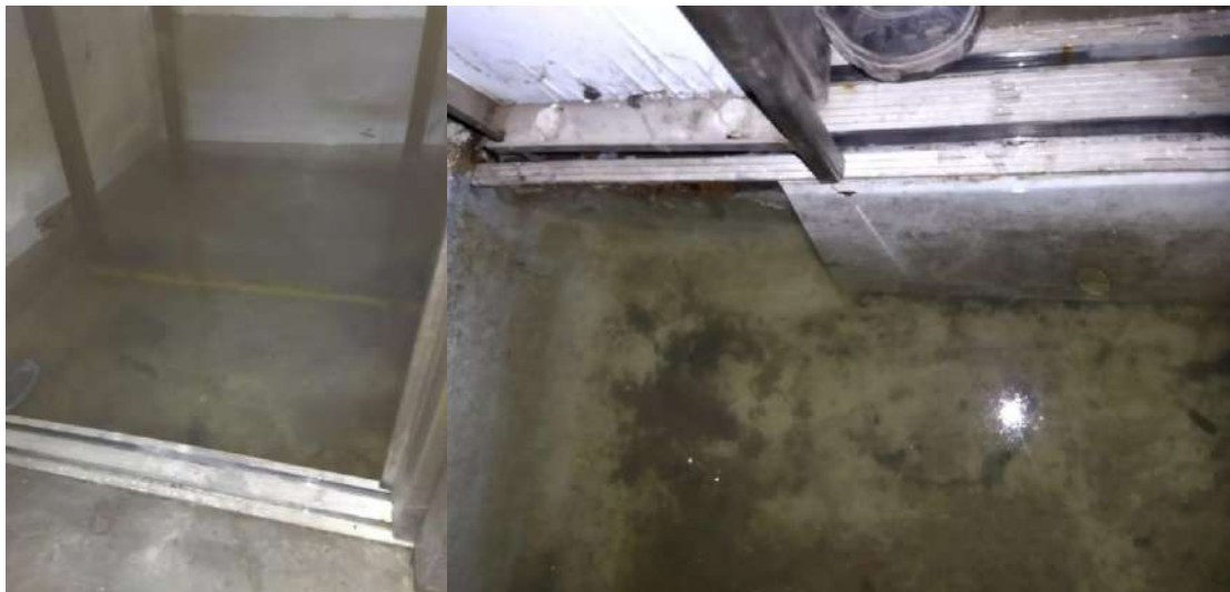
Figuras 51 e 52 - Acúmulo de água no poço do elevador.
