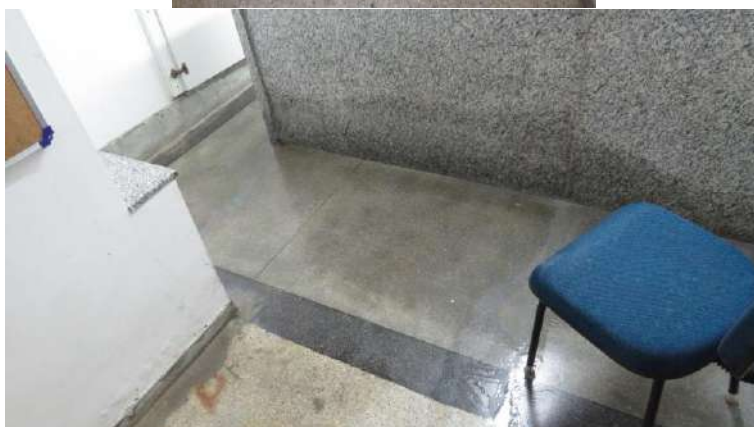
Figuras 30 e 31 - Algumas peças de granito úmidas devido ao alagamento.
