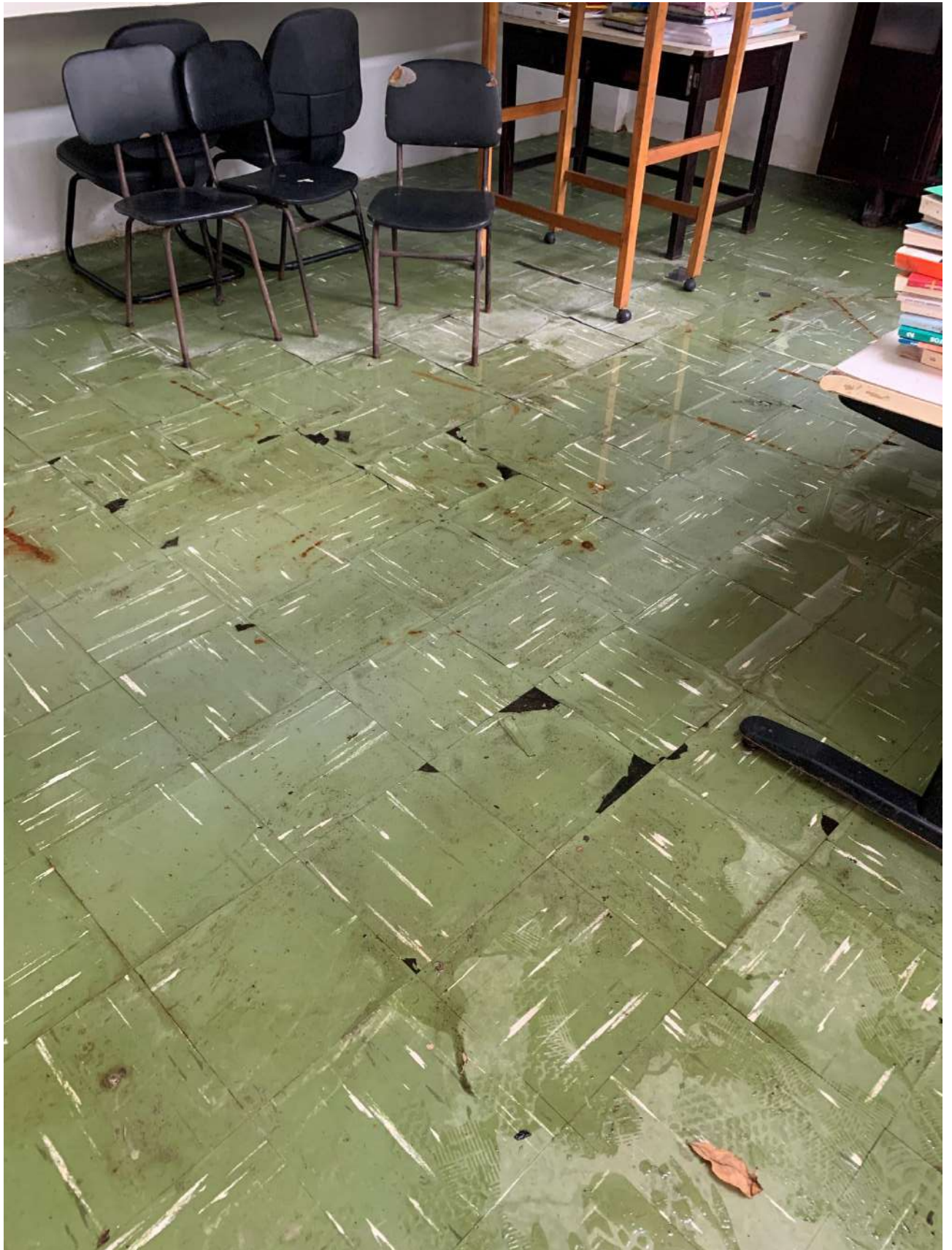
Figura 33. Piso com acúmulo de água de chuva em sala administrativa abaixo da quadra de esportes CAP
