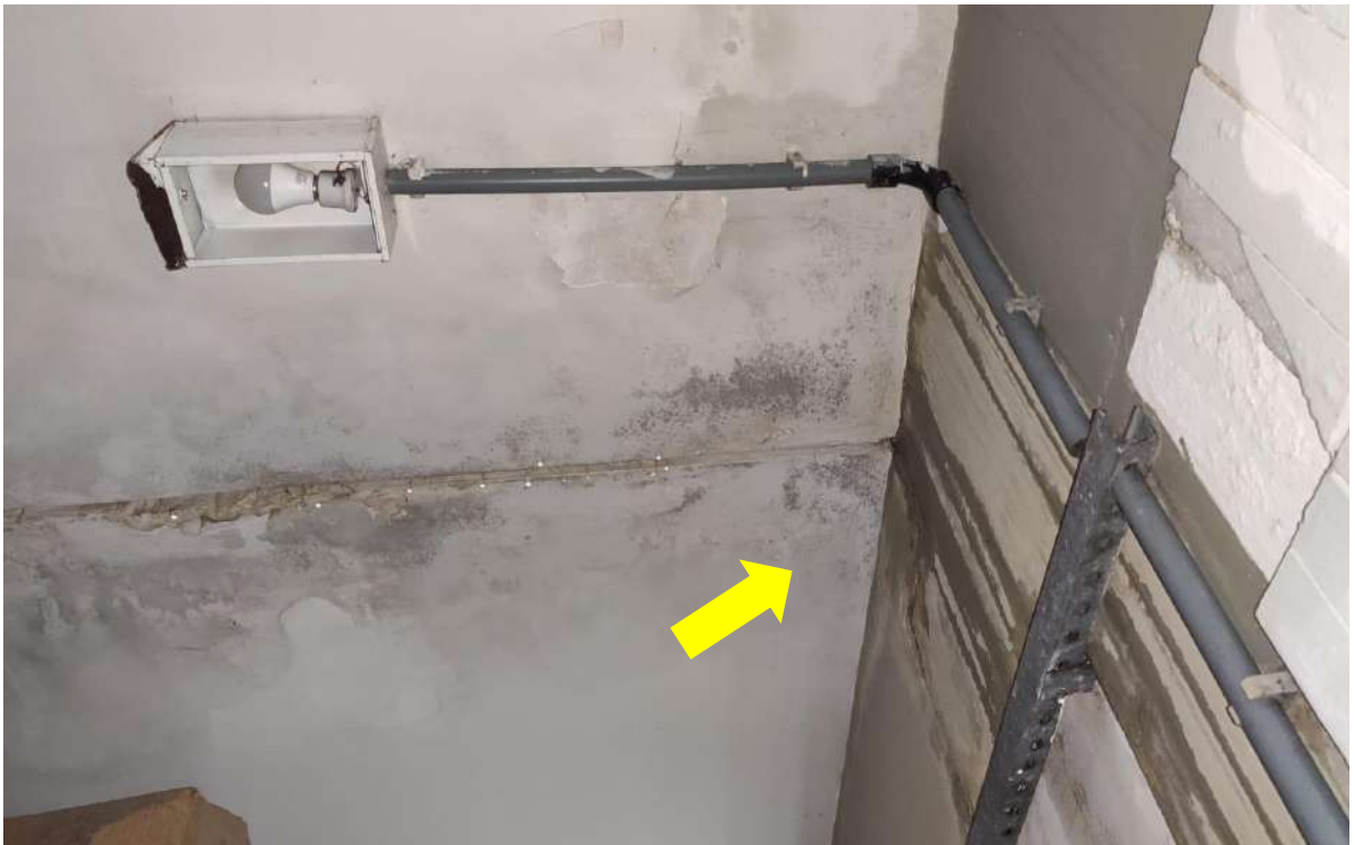
Figura 19. Infiltração no teto no Prédio da Reitoria (PROGEPE térreo)
