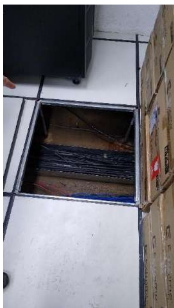
Fiação molhada no piso falso da central de lógica do NTI (centro nervoso da UFPE)
