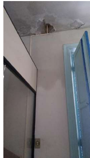
Infiltração no teto
