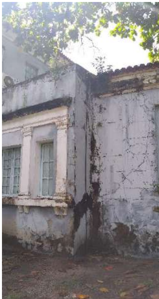
Fachada externa do anfiteatro no ponto mais crítico de infiltração.
