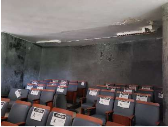
Foto 10: Área da plateia do Auditório com indicações infiltrações.
