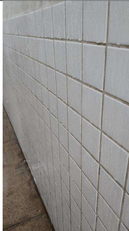
Figura 5: Cerâmica com muita umidade, escorrendo pela parede
