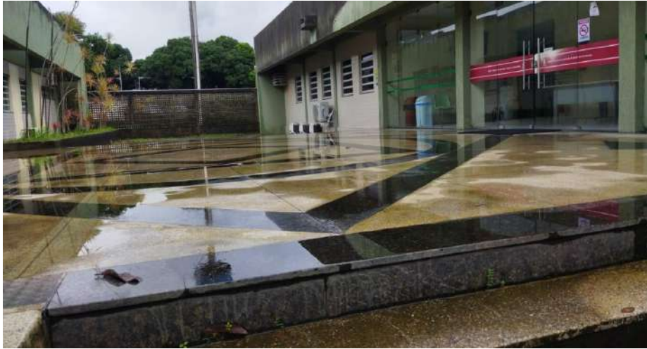
Figura 1: Acúmulo de água no Hall de ligação entre o UNATI e o SPA.
