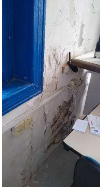
Recepção da covest. Muita infiltração na parede interna à fachada oeste.
