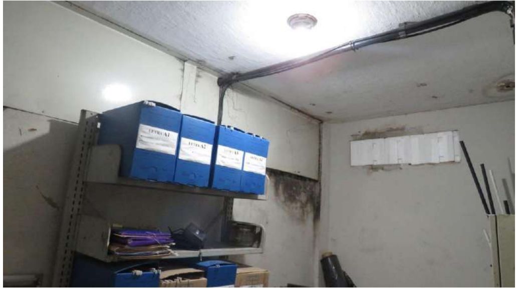
Figuras 65 a 70 - Alguns pontos de infiltração no prédio do NEG-LABISE.
