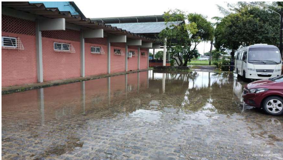
FOTO 09 - ACÚMULO DE ÁGUA NO ACESSO AO SEGEL
