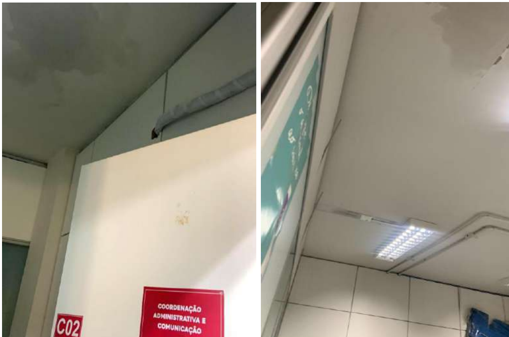
Imagem 10 - Ambientes administrativos com umidade no forro
