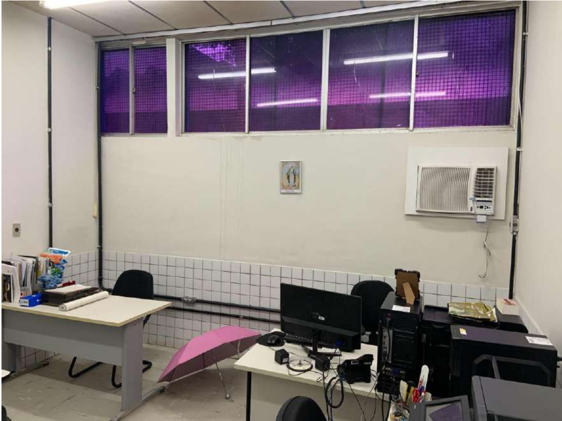
Imagem 05 - Ambiente Processo Técnico, apenas com infiltração leve pela esquadria
