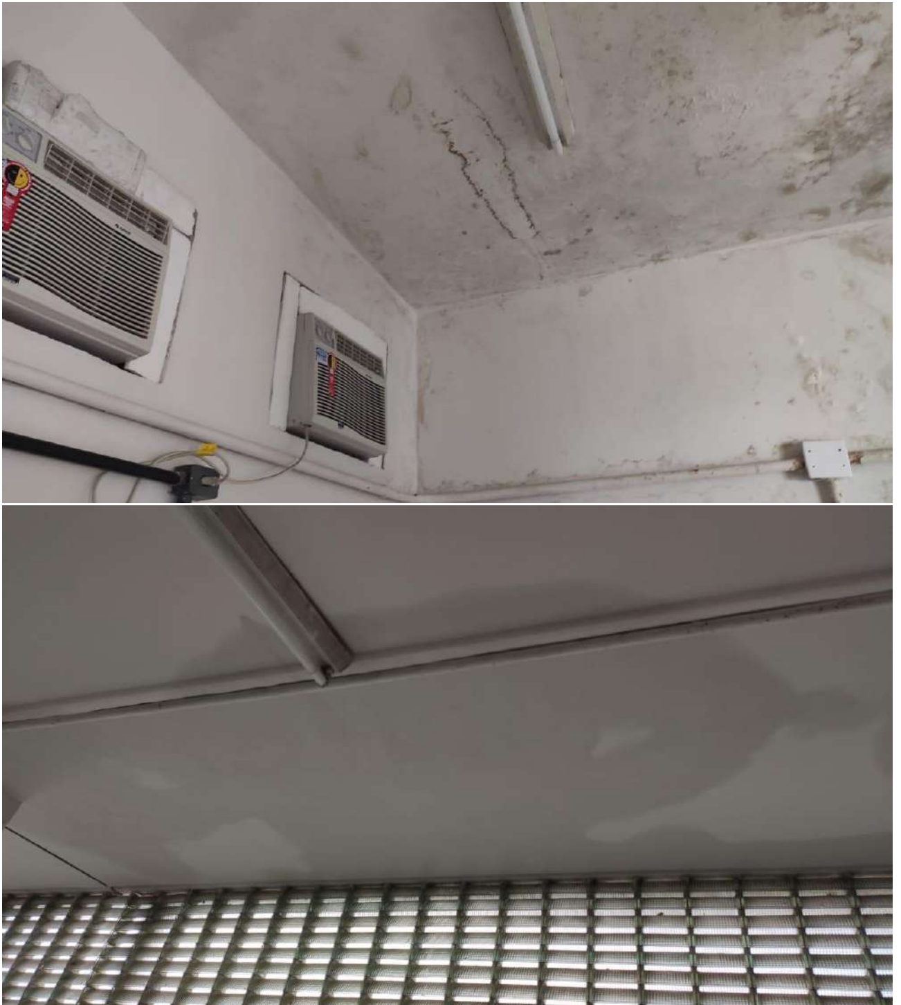
Figura 26. Infiltração no teto LAFINNT - Laboratório de Fisiologia da Nutrição (Depto Nutrição)
