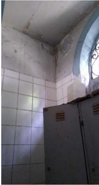
Depósito do banheiro masculino, embaixo da sala da coordenação, por onde corre tubulação exposta que está com vazamentos.
