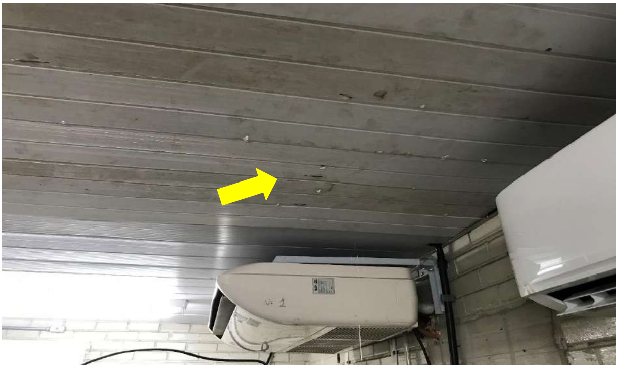
figura 24. Vazamento em teto na Rádio Universitária (Sala do Transformador)
