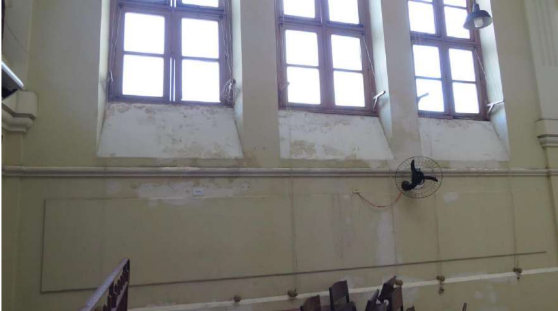
Figuras 38 a 43 - Alguns pontos de infiltração nas salas do primeiro pavimento.
