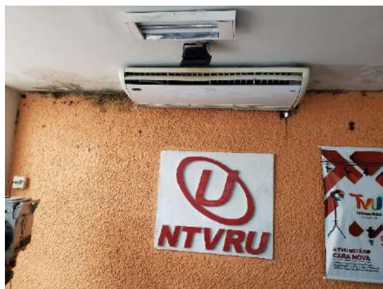
Foto 04: Infiltrações da cobertura em outro ponto da recepção..
