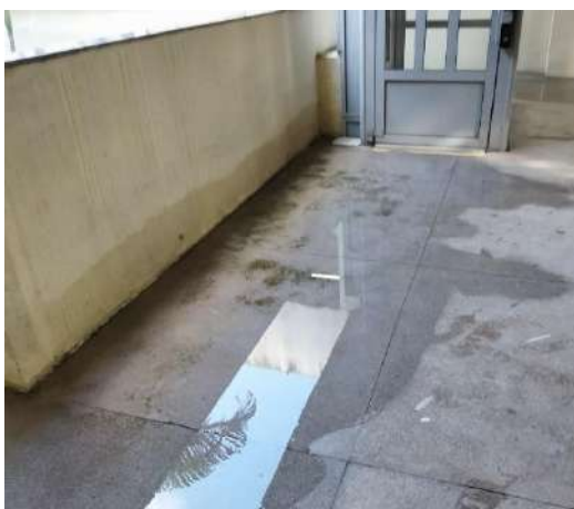
Corredor do 1º andar com acúmulo de água das chuvas em todo o piso.
