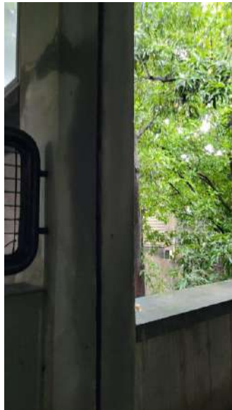
Umidade nos pilares onde há junta de dilatação.
