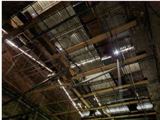
Foto 17: Várias telhas danificadas no galpão sobre o Estúdio B.
