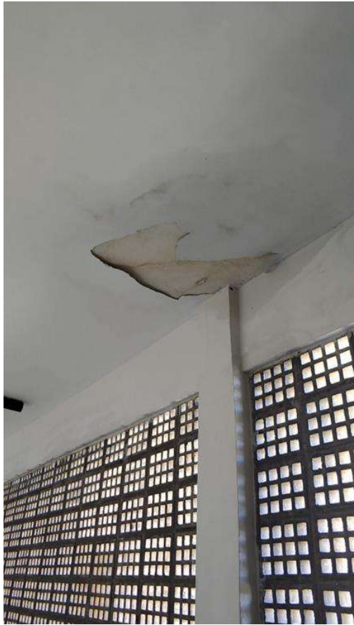
Vazamento teto corredor 1° andar
