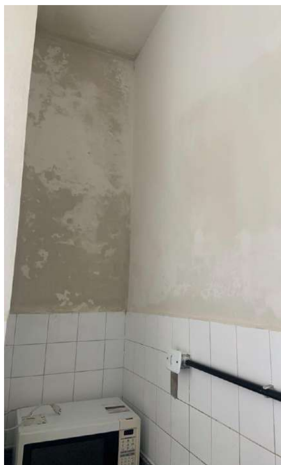
Imagens 17 e 18 - Infiltrações através de jardineira na circulação de um dos pavimentos e em ambiente de copa
