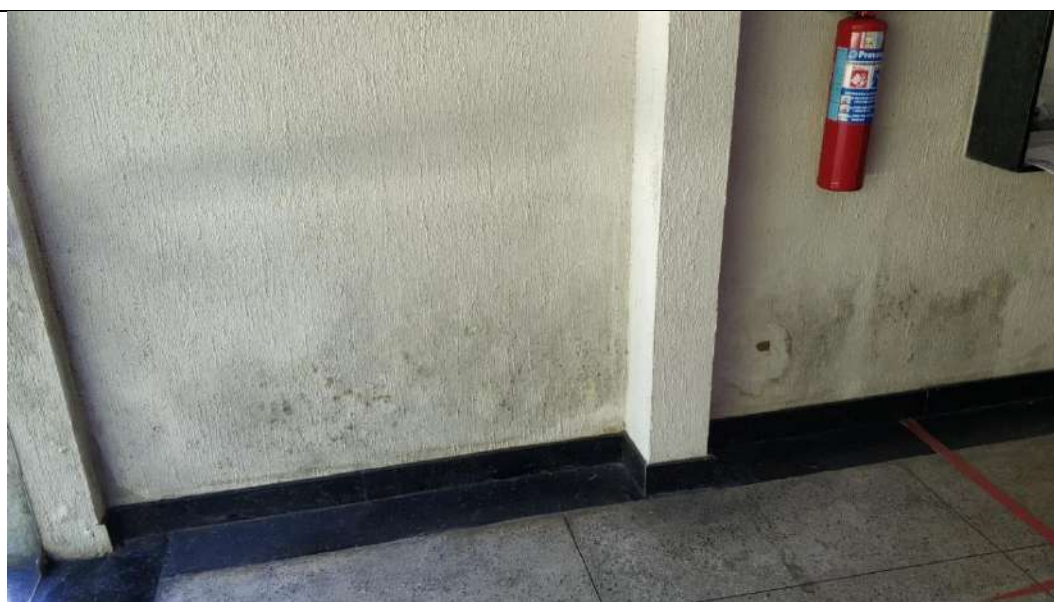
Figura 3: Umidade Hall entrada
