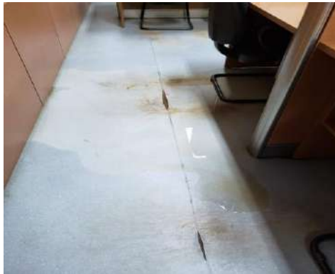
Piso em paviflex danificado pelas infiltrações
