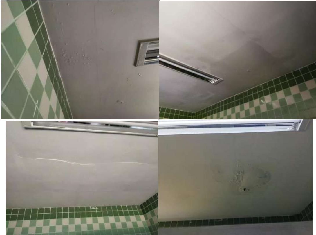
Figuras 3 a 6: infiltração no forro dos WC's masculino e feminino.
