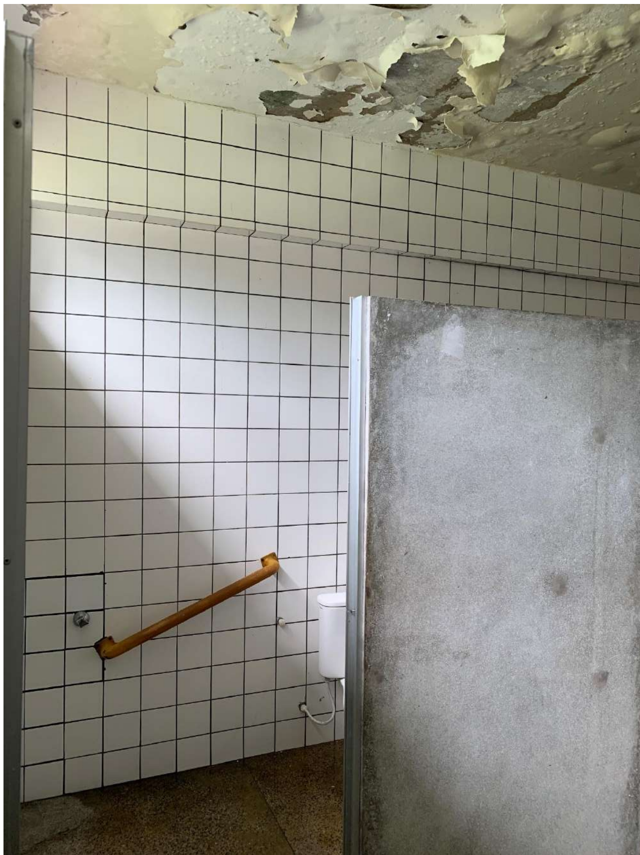
Figura 31. Infiltração em teto no vestiário masculino na quadra de esportes CAP
