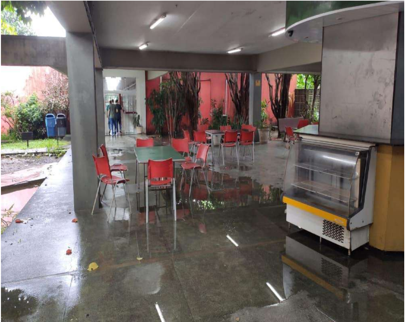
Figura 4. Área de Convivência alagada (CCSA)
