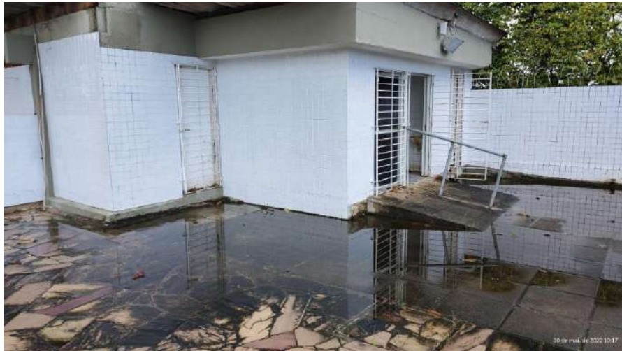
FOTO 08 - ACÚMULO DE ÁGUA NA ÁREA EXTERNA DA PISCINA
