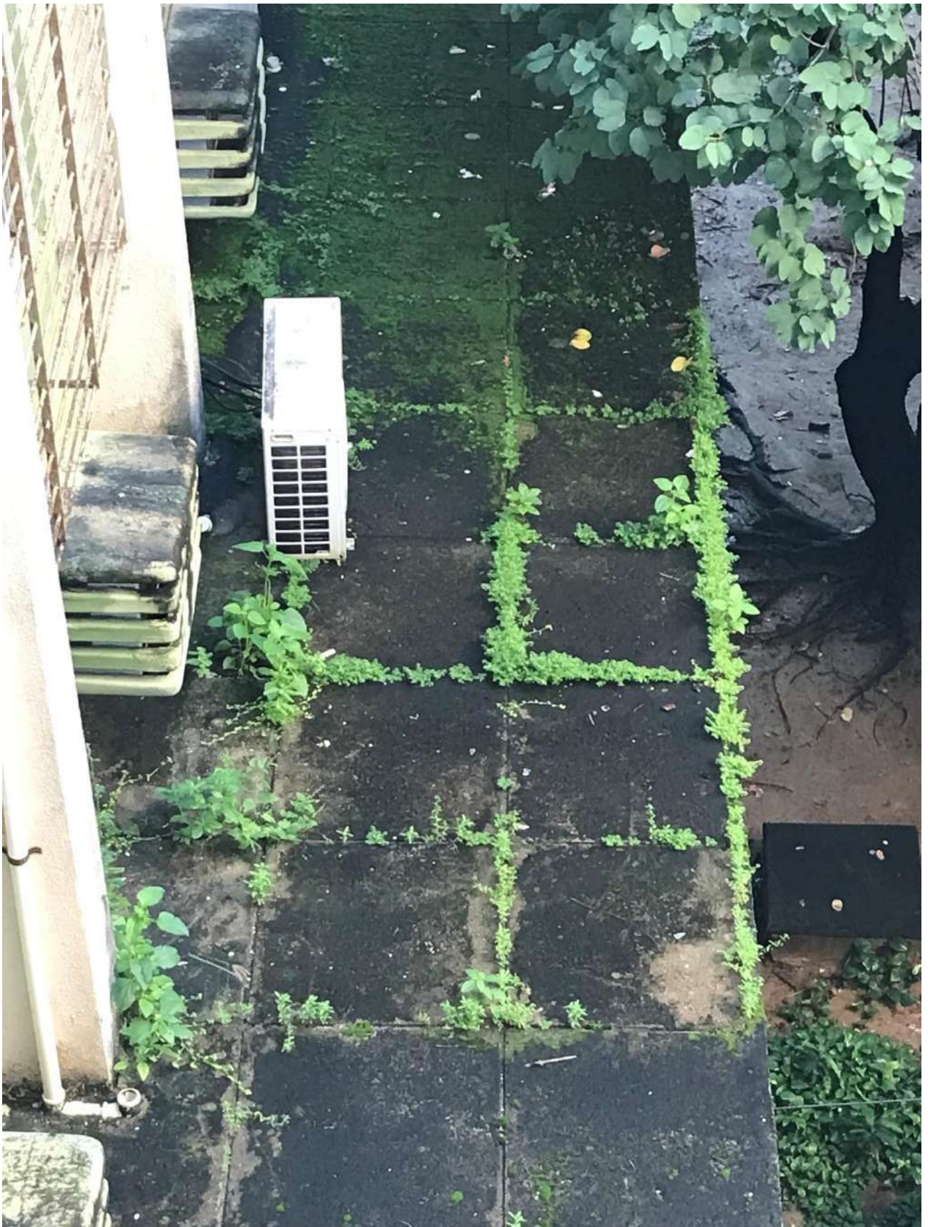
Figura 2. Laje com acúmulo de matéria orgânica (CCS)
