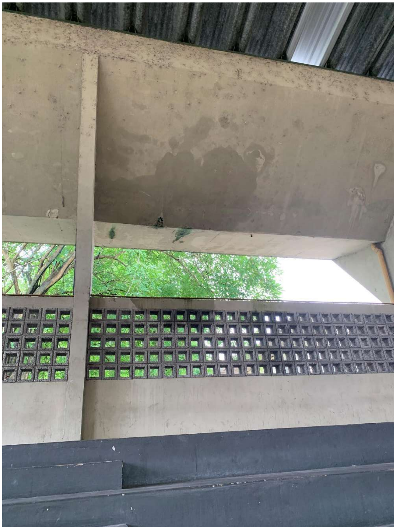
Figura 30. Vazamento em estrutura de drenagem na quadra de esportes CAP
