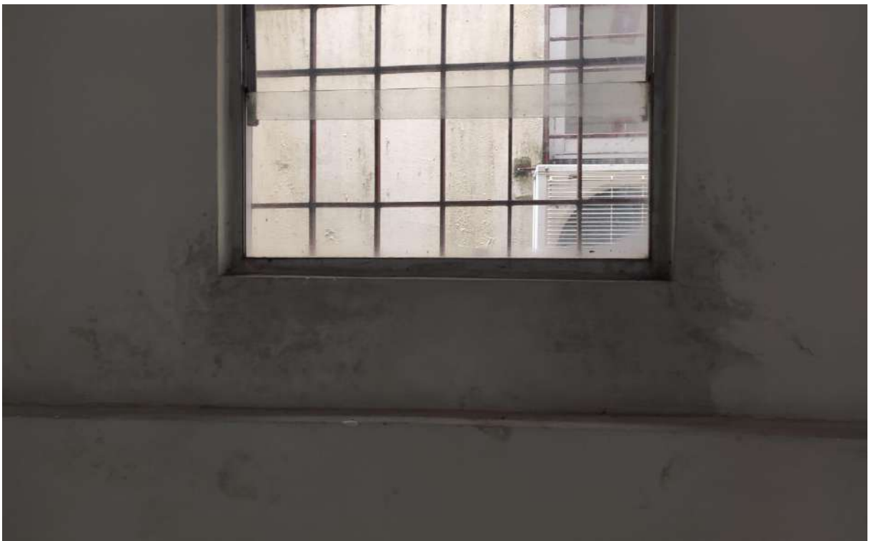
Figura 1. Infiltração pela janela na escada de acesso ao 2º pavimento (Bloco Acadêmico Depto Nutrição)
