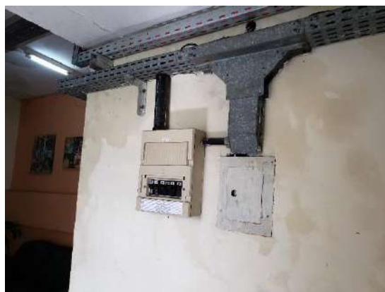
Foto 10: Umidades próximo aos quadros de força.
