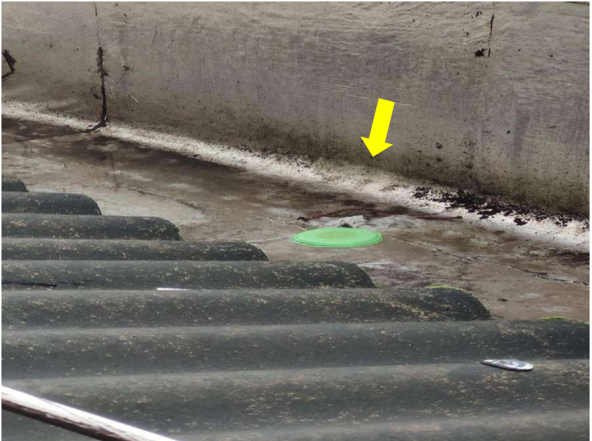
Figura 27. Materiais descartados na calha do 1º andar no Prédio da Reitoria (face Norte)
