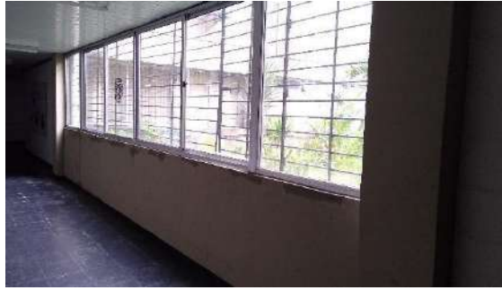
Corredor Dept. Expressão Gráfica (Térreo). Esquadrias com infiltração.
