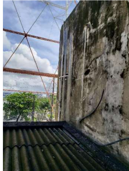
Foto 16: Vazamento por sobre a laje de tampa do reservatório superior.
