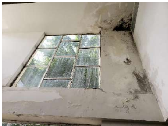
Foto 03: Área da recepção onde há vazamentos da cobertura e infiltrações pela esquadria.
