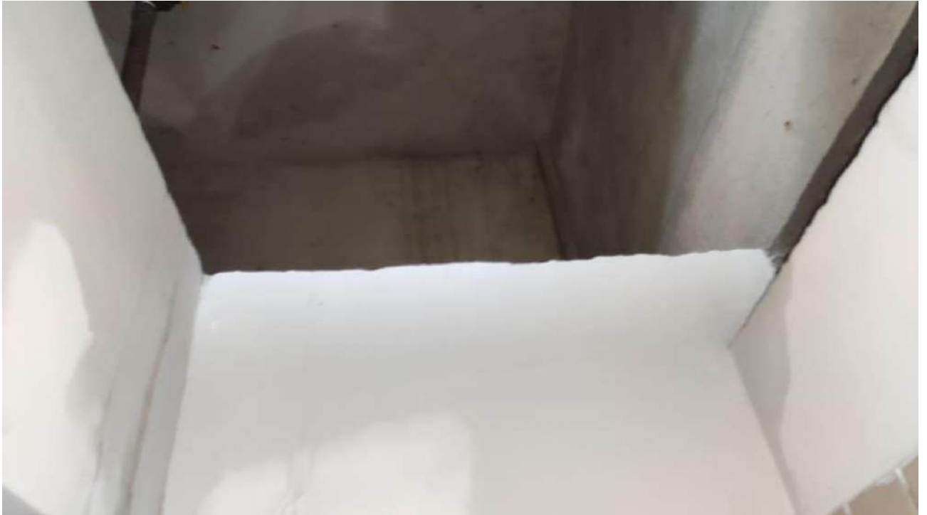
Figura 21. Infiltrações no teto no corredor de acesso à cobertura 2º pavimento (Depto Nutrição)
