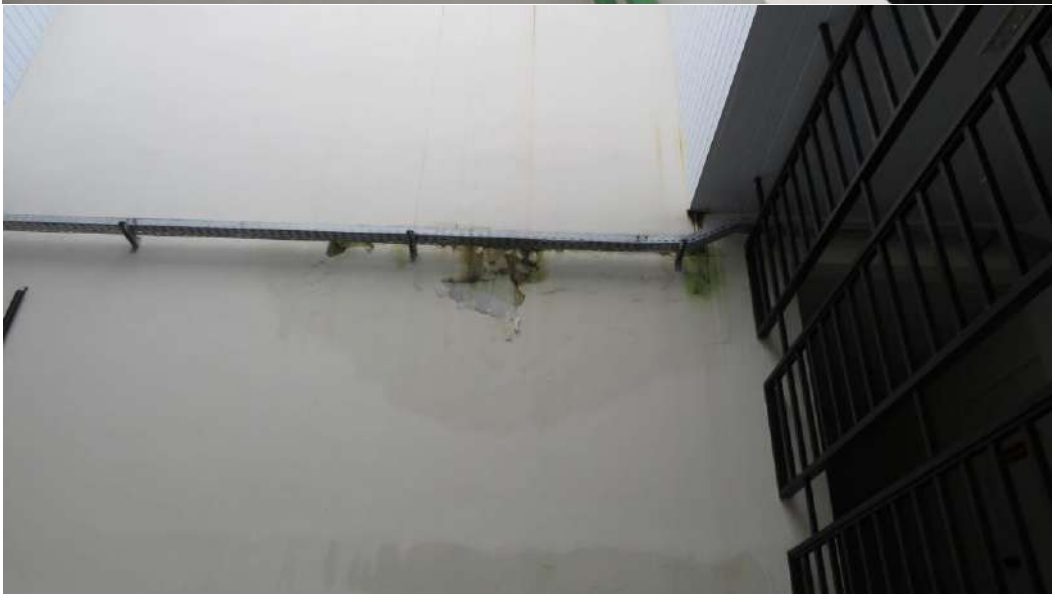
Figuras 56 a 59 - Pontos de acúmulo de água e infiltração no Departamento de Engenharia Naval.
