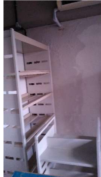
Biblioteca - sala da coordenação, outro ângulo. Infiltração nas paredes.
