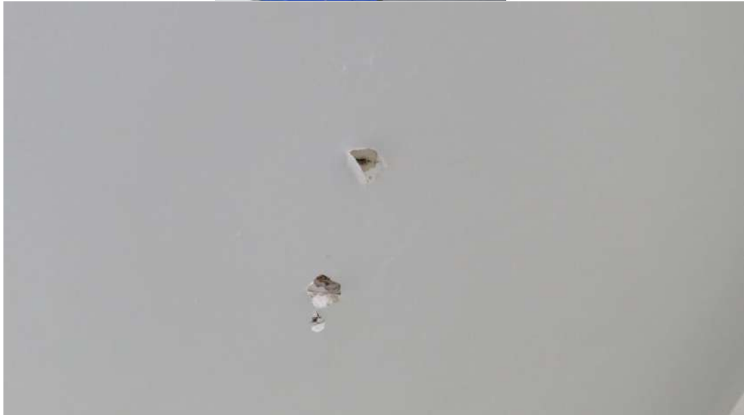
Figuras 7 e 8 - Infiltração na laje da Sala 07.
