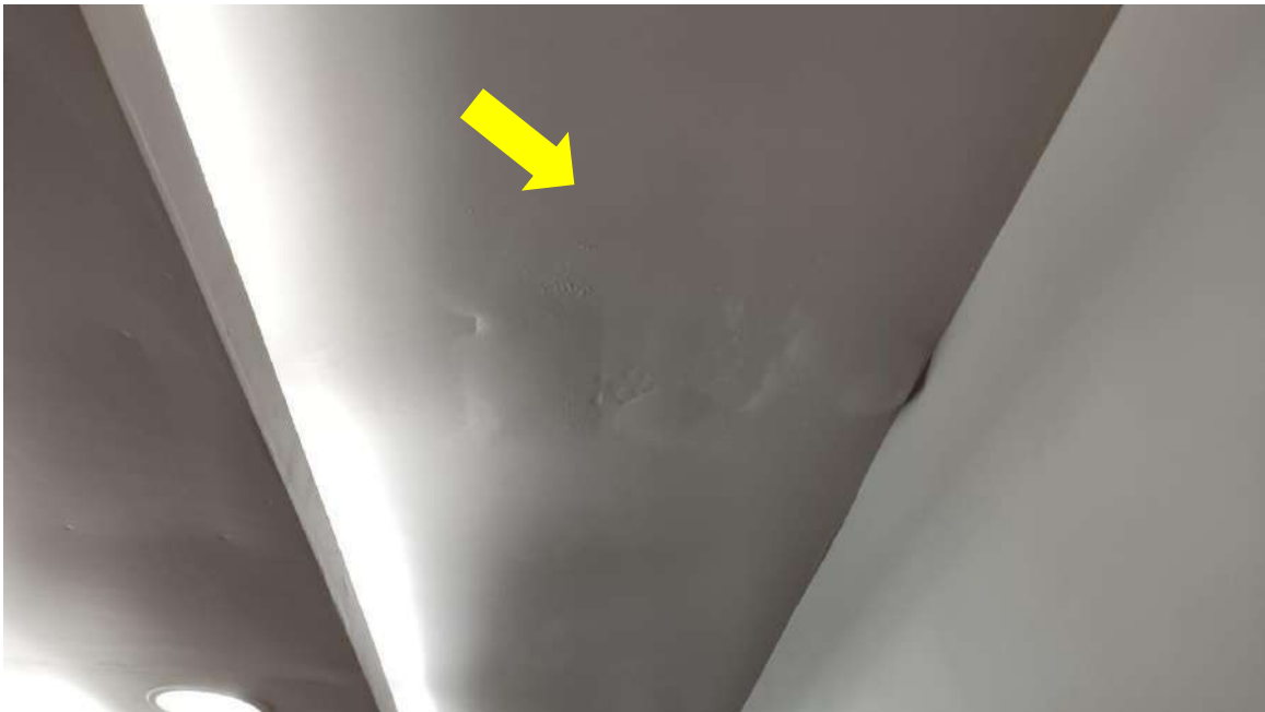
Figura 39. Infiltração na cobertura no Prédio da Reitoria (Auditório João Alfredo)
