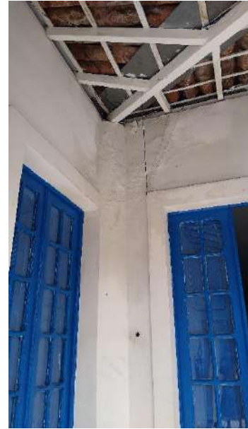
Corredor externo com bastante infiltração da coberta.
