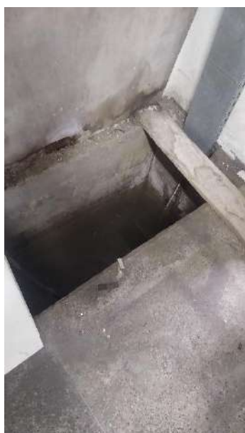
Poço da subestação que alimenta o prédio. Fiação submersa na água.
