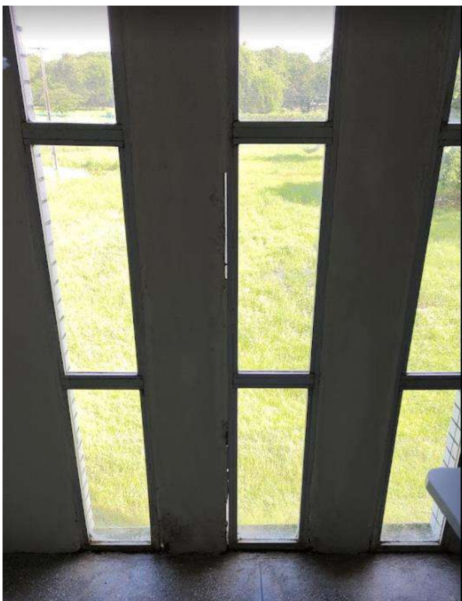
FOTO 06 - ESQUADRIA COM PROBLEMA DE VEDAÇÃO
