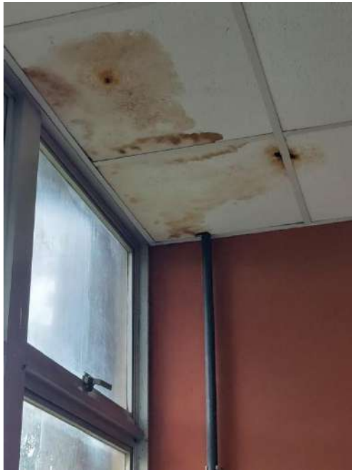
Detalhe forro danificado
