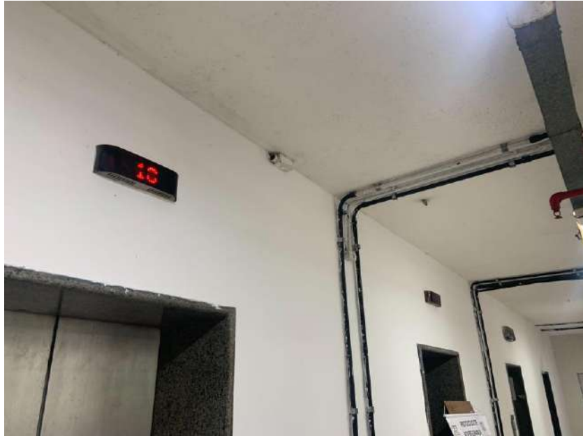
Imagem 05 - Um dos dois elevadores em funcionamento, dentre quatro
