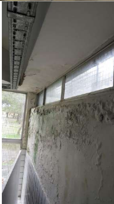
Figuras 16 a 26 - Alguns pontos críticos das infiltrações na biblioteca.
