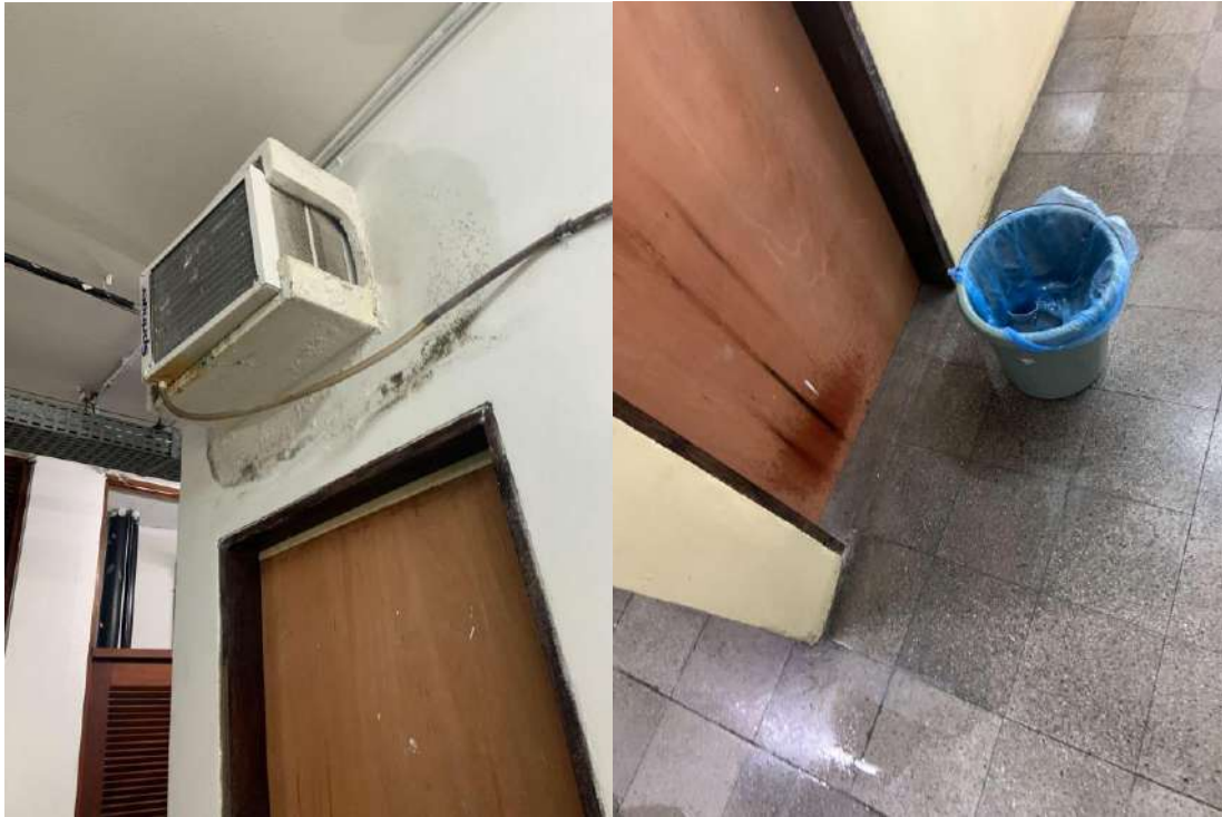
Imagens 25 e 26 - Aparelho de ar-condicionado, encontrado ligado atendendo a sala fechada, gerando problema de escoamento de água e umidificação da parede
