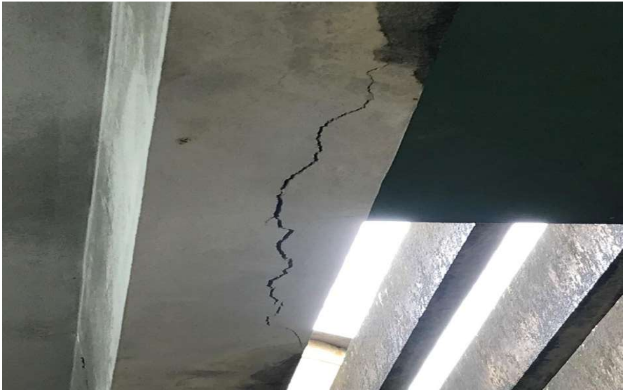
Figura 12. Rachadura em viga no Prédio Anexo de Anatomia CB
