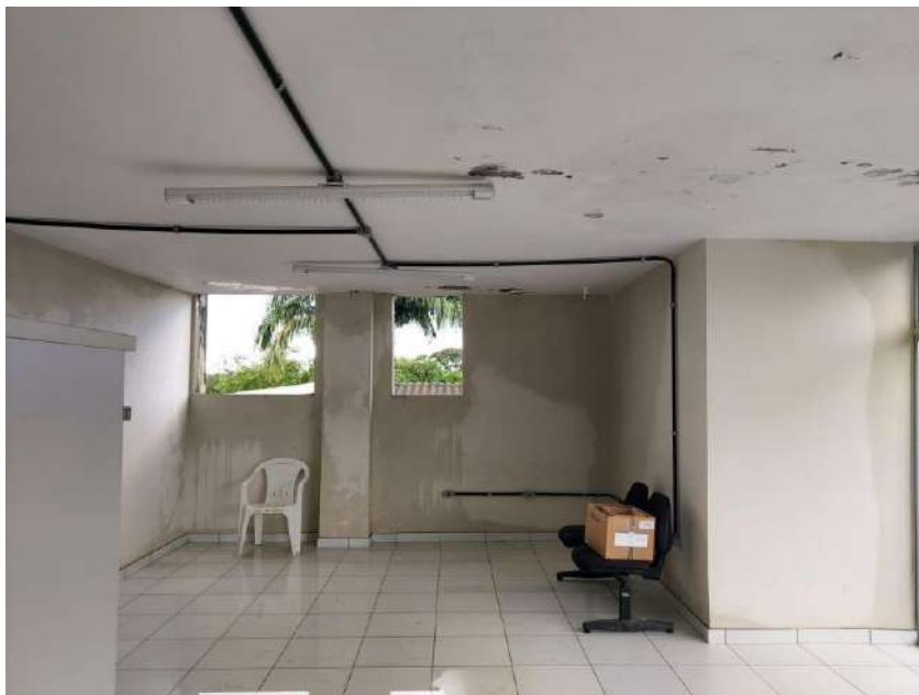
Ausência de esquadrias
