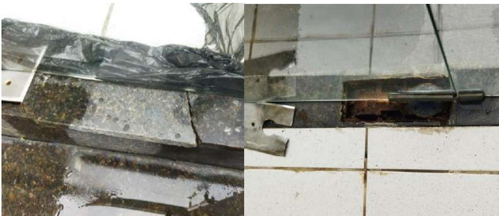
Figuras 11 e 12: soleira quebrada e mola enferrujada, resultando na inclinação das portas da Recepção.
