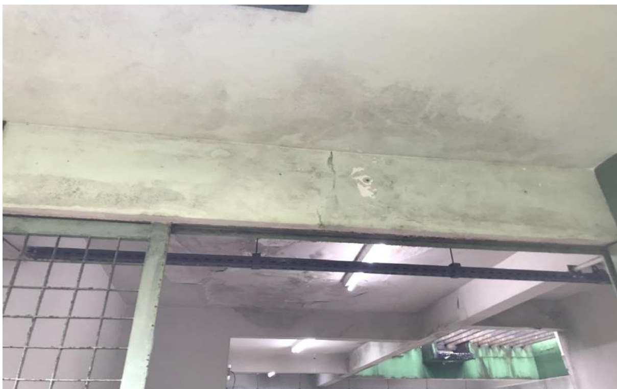
Figura 26. Infiltração na laje no Prédio Anexo de Anatomia CB
