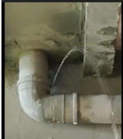
FOTO 04 - VAZAMENTO DECORRENTE DE OBSTRUÇÃO NO SISTEMA DE DRENAGEM DE ÁGUAS PLUVIAIS DA EDIFICAÇÃO
